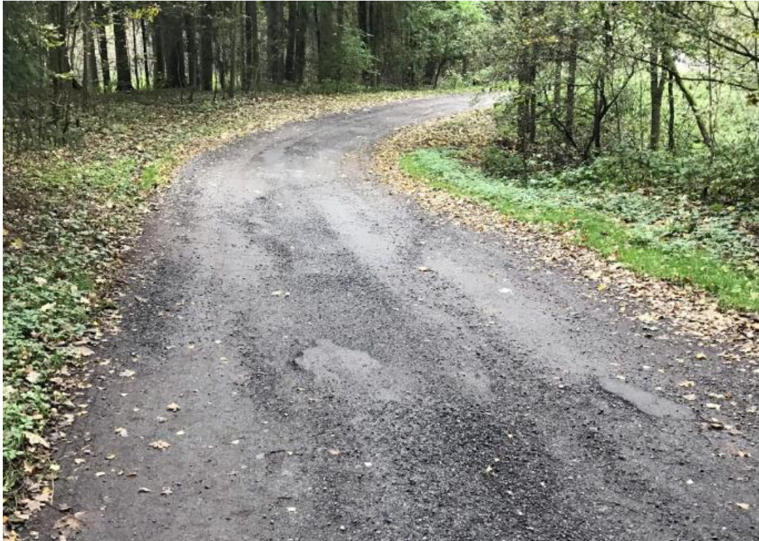
Typisches Schadensbild Himmelreichstraße (ID 0308)
