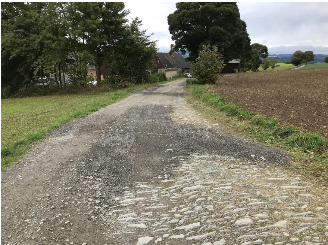
Typisches Schadensbild Huthweg (ID 0121)
