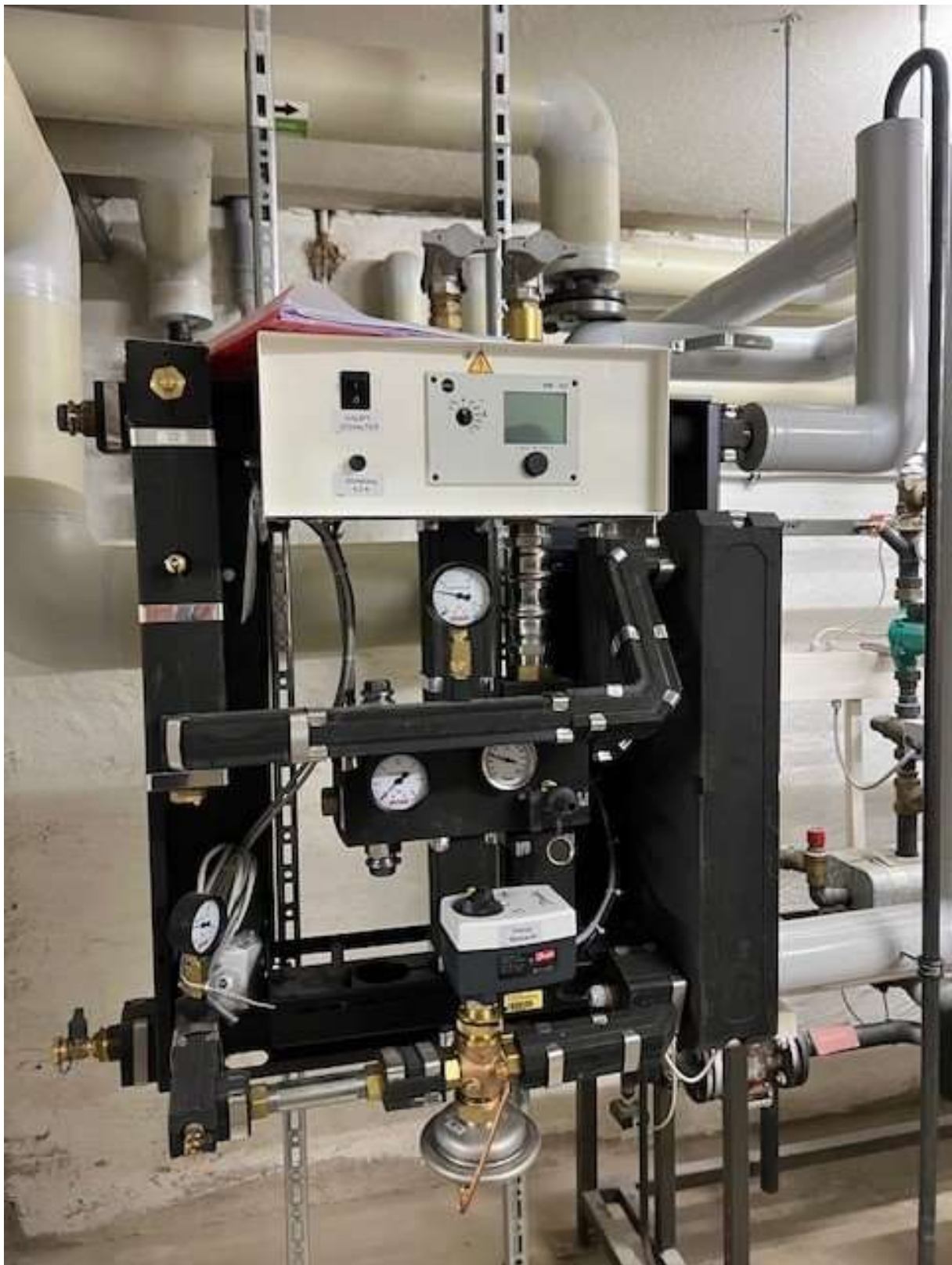
Foto 2 – Kompaktstation für RLT-Anlage, Thünen-Haus
