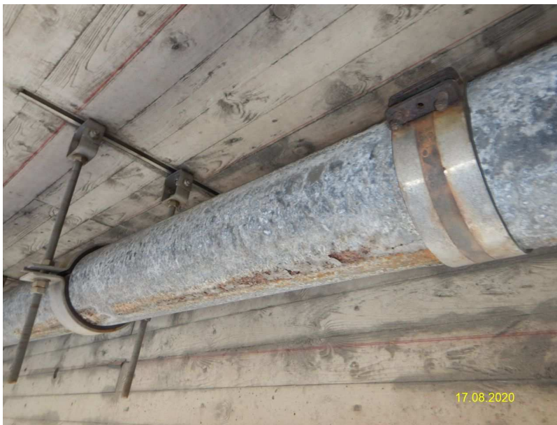
2020H-053- ENTWÄSSERUNG STELLENWEIS KORRODIERT
