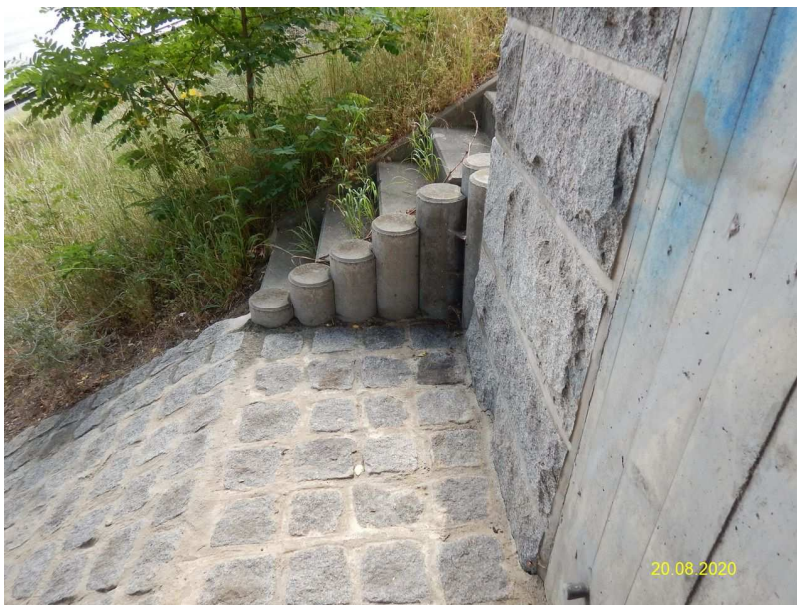
2020H-060-BÖSCHUNGSTREPPE NICHT FACHGERECHT UND BEWACHSEN
