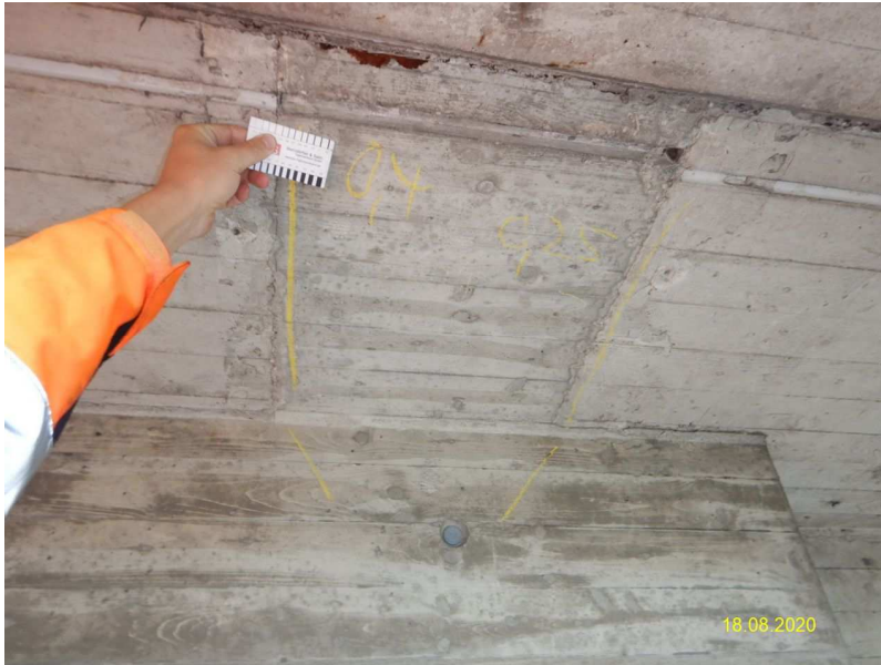
2020H-072-KRAGARM BETONIERFUGE OFFEN GERISSEN ÜBER PFEILER
