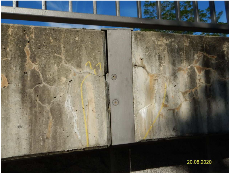
2020H-039-GESIMS AN FÜK VORNE LINKS GERISSEN MIT AUSSINTERUNGEN
