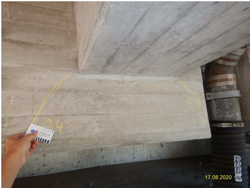
2020H-011-ENDQUERTRÄGER MEHRFACH QUERRISSE HINTEN
