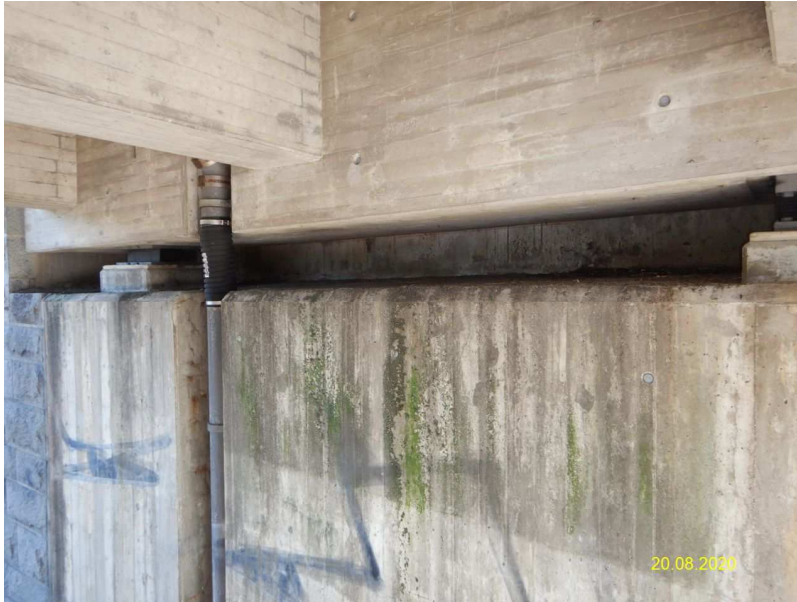
2020H-078- WIDERLAGER AUFLAGERBANK DURCHFUCHTET WL VORNE
