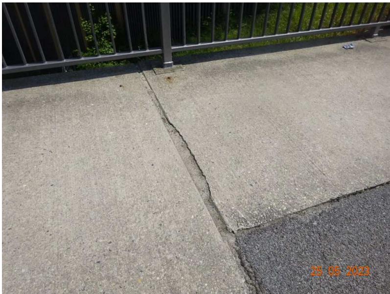
2023E_KAPPENOBERFLÄCHE ABGEPLATZT HINTEN LINKS
