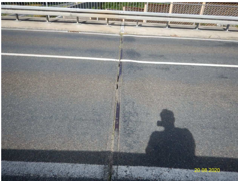
2020H-073-FÜK ZUGESETZT FUGE ANSCHLUSS BELAG FEHLT
