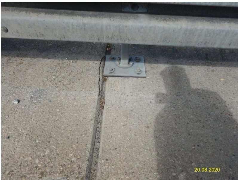
2020H-047-SCHUTZEINRICHTUNG VERANKERUNG NICHT WIRKSAM BETON GEBROCHEN
