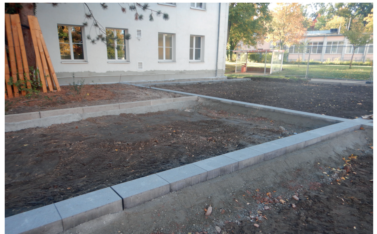
Abb. 08: Bestand - Rückenstütze der zu schützendes Einfassung
