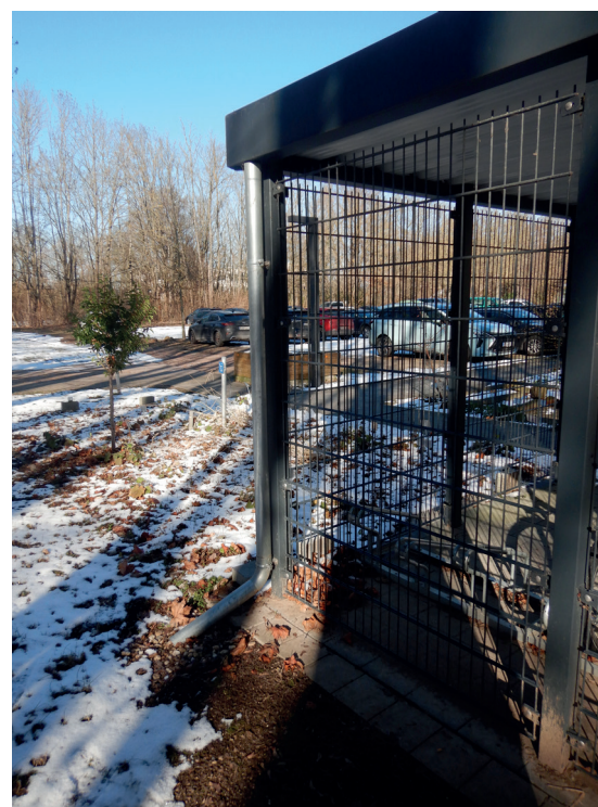
Abb. 13: Überdachung FLEXIBOX Ziegler Ableitung von Niederschlag
