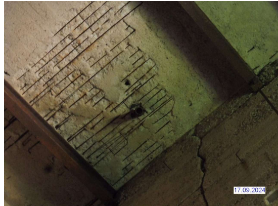
H2024_ÜBERBAU BETONABPLATZUNG MIT FREILIEGENDER BEWEHRUNG_VORN INNEN
