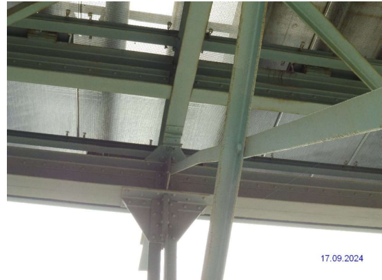
H2024_ÜBERBAU AUSSTEIFUNGSVERBAND VERBOGEN
