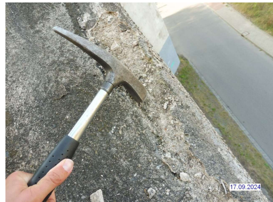
H2024_FLÜGEL OBERSEITE GERISSEN UND HOHLKLINGEND_HINTEN LINKS
