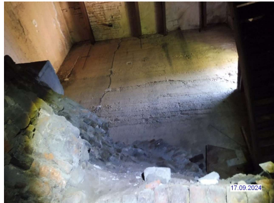
H2024_WIDERLAGER GERISSEN_VORN INNEN
