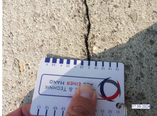
H2024_ÜBERBAU LÄNGSRISSE_VORN OBEN
