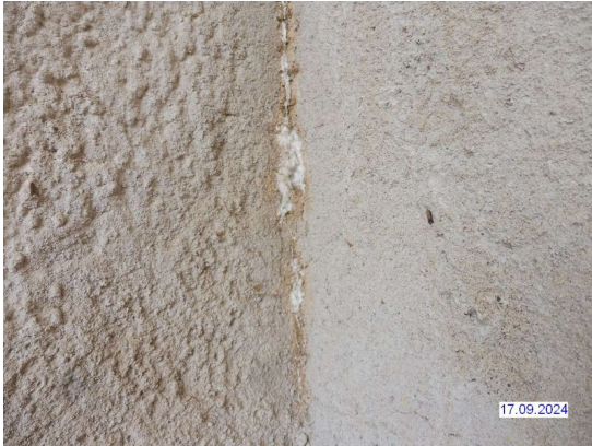
H2024_WIDERLAGER SPRITZBETONINSTANDSETZUNG LÄNGSRISS MIT AUSSINTERUNG_HINTEN
