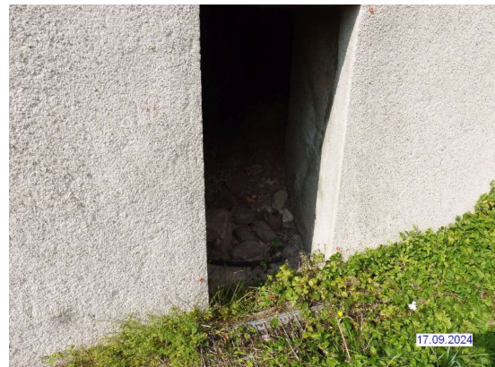
H2024_WIDERLAGER BESICHTIGUNGSTÜR OHNE BEFUND_VORN
