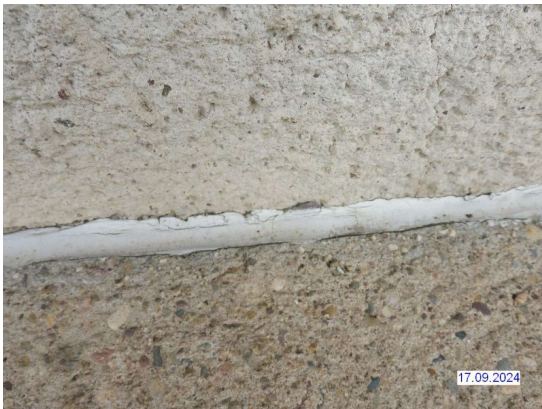
H2024_PFEILER FUGENFÜLLUNG VERSCHLISSEN
