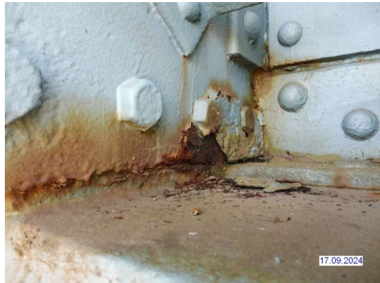
H2024_FACHWERKKNOTEN KORROSIONSSCHUTZ SCHADHAFT MIT BEGINNENDEM QUERSCHNITTVERLUST
