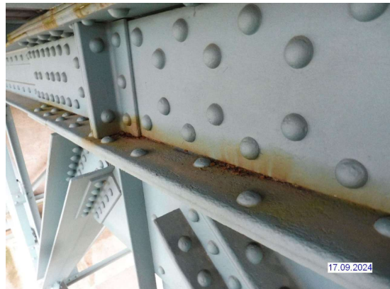
H2024_ÜBERBAU MEHRFACH KORROSIONSNARBEN
