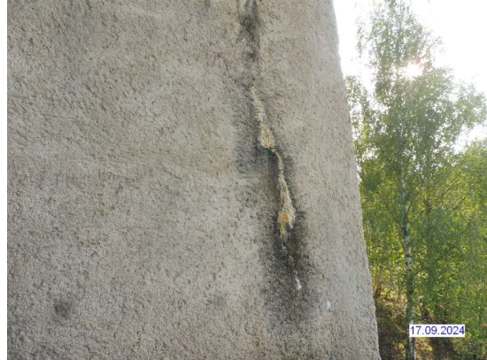
H2024_KAMMERWAND LÄNGSRISS MIT AUSSINTERUNGEN UND WASSERAUSTRITT_HINTEN
