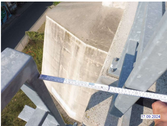
H2024_GELÄNDER NICHT FACHGERECHT_VORN UND HINTEN RECHTS
