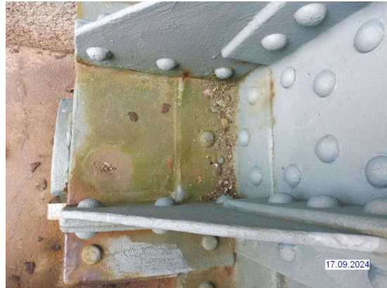
H2024_ÜBERBAU KORROSIONSSCHUTZ OBERSEITIG BEMOOST
