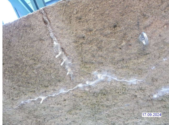
H2024_WIDERLAGER NETZRISSE MIT AUSSINTERUNGEN UND WASSERAUSTRITTHINTEN_HINTEN
