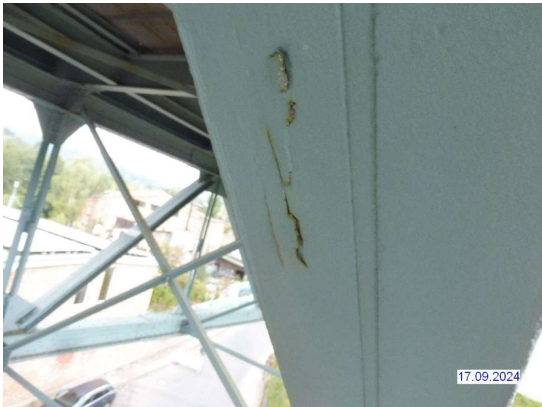
H2024_ÜBERBAU DIAGONALSTAB FEHLSTELLE
