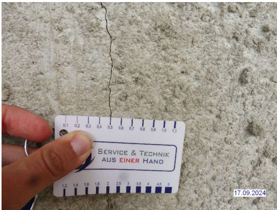
H2024_WIDERLAGER NETZRISSE TEILWEISE MIT AUSSINTERUNGEN_VORN UND HINTEN
