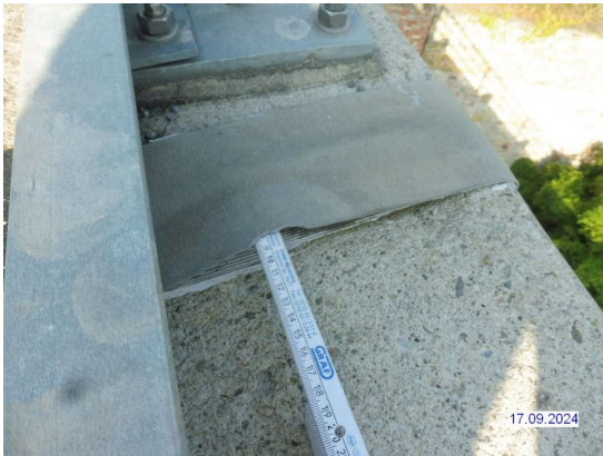
H2024_ÜBERBAU INSTANDSETZUNG QUERRISS SCHADHAFT_VORN OBEN
