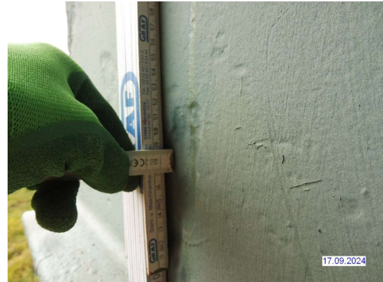
H2024_QUERTRÄGER MEHRFACH TIEFE KORROSIONSNARBEN
