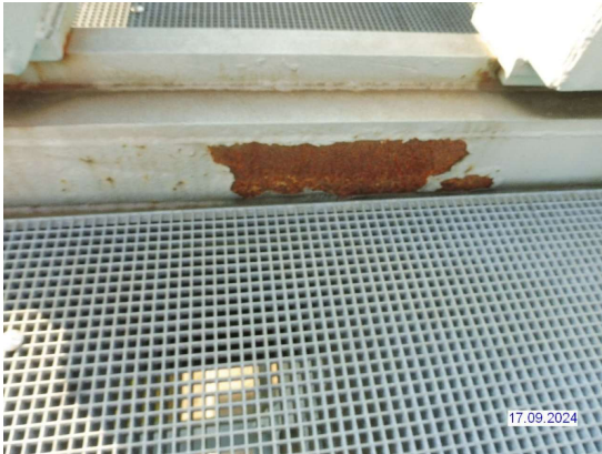
H2024_GLEISTRÄGER PUNKTUELL KORROSION
