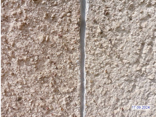
H2024_WIDERLAGER FUGENFÜLLUNG VERSCHLISSEN_VORN
