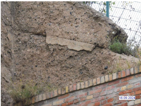
H2024_FLÜGEL BETONOBERFLÄCHE GROSSFLÄCHIG ABGEPLATZT_VORN LINKS
