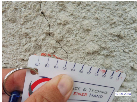
H2024_PFEILER UNTERTEIL LÄNGSRISSE
