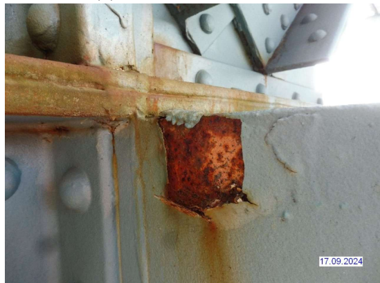
H2024_ÜBERBAU KORROSIONSSCHUTZ MEHRFACH SCHADHAFT ROST
