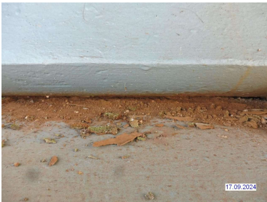
H2024_KIPLAGER KONTAKTFLÄCHE VERSCHMUTZT UND KORRODIERT_ALLE
