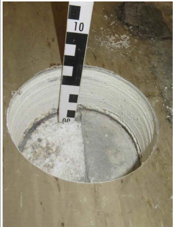
Raum 8 EG Probe/Analyse: Trennlage Fußbodenaufbau
