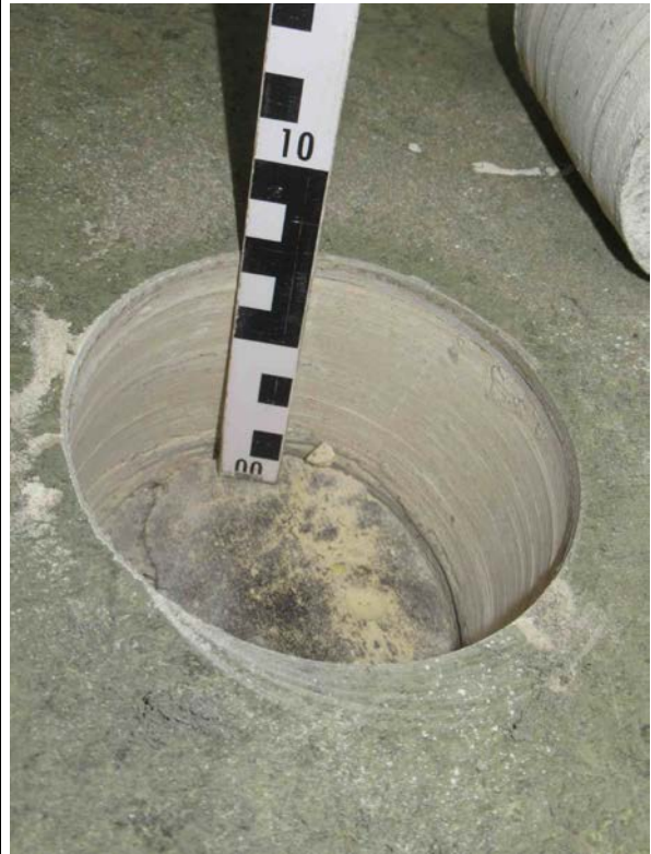
Raum 12 EG Probe/Analyse: Trennlage Fußbodenaufbau
