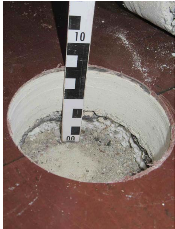
Raum 17 EG Probe/Analyse: Trennlage Fußbodenaufbau
