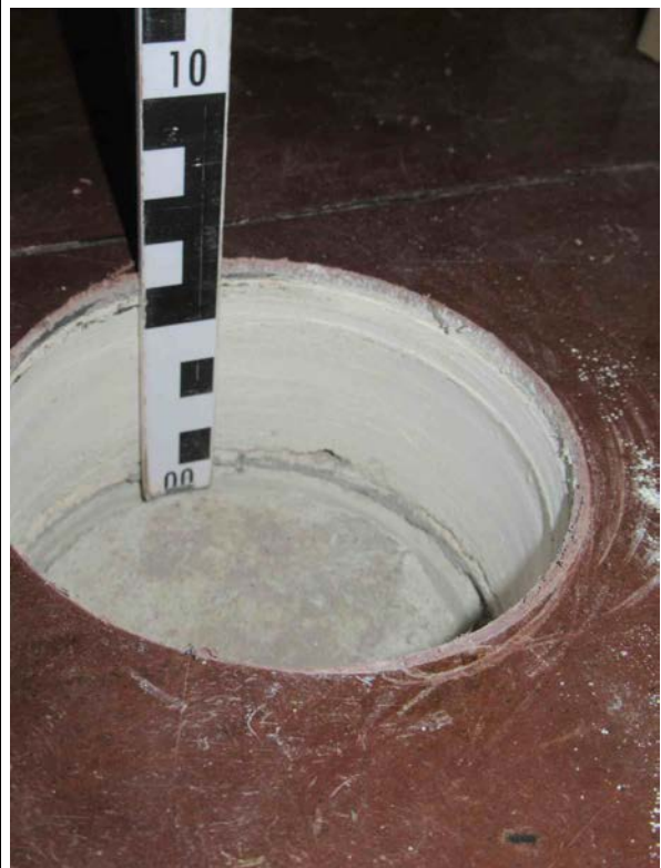
Raum 16 EG Probe/Analyse: Trennlage Fußbodenaufbau
