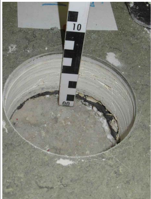
Raum 11 EG Probe/Analyse: Trennlage Fußbodenaufbau
