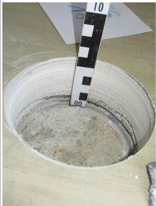
Raum 18 EG Probe/Analyse: Trennlage Fußbodenaufbau
