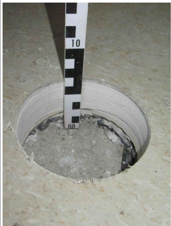
Raum 13 EG Probe/Analyse: Trennlage Fußbodenaufbau
