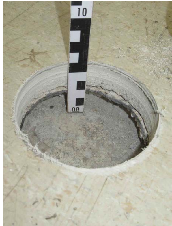
Raum 14 EG Probe/Analyse: Trennlage Fußbodenaufbau
