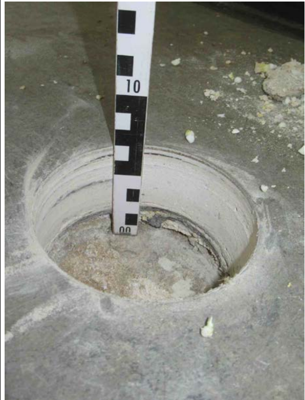
Raum 19 EG Probe/Analyse: Trennlage Fußbodenaufbau
