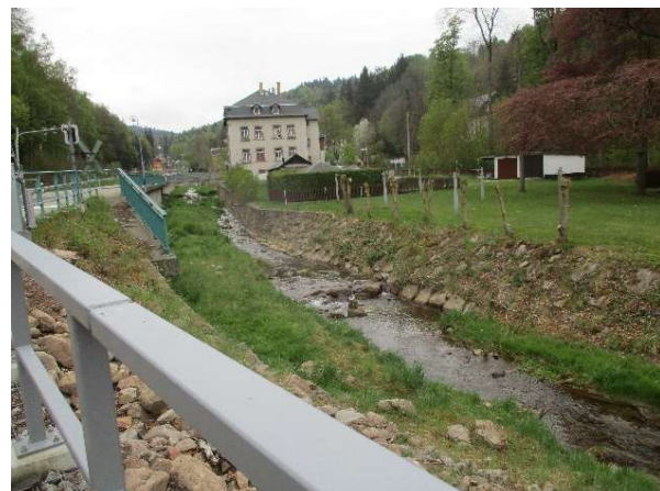
Bild 10: Schädelle bei Altenberger Str. 6 (Schaden 2001496)
