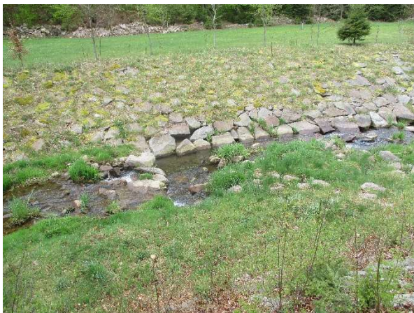
Bild 3: Schadstelle bei Altenberger Str. 44 / Bushaltestelle „Mühle“ (Schaden 2001508)
