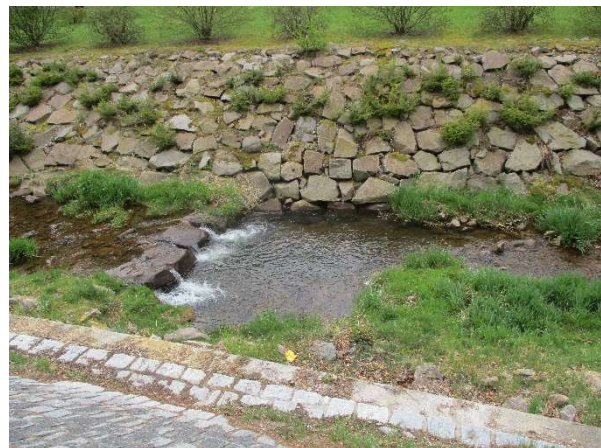
Bild 4: Schadstelle bei Brücke Steinweg 6 (Schaden 2001510)
