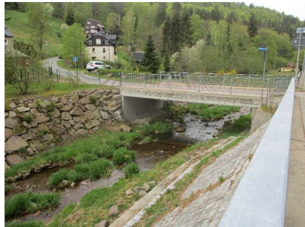
Bild 6: Schädelle bei Brücke Steinweg 6 (Schaden 2001510)
