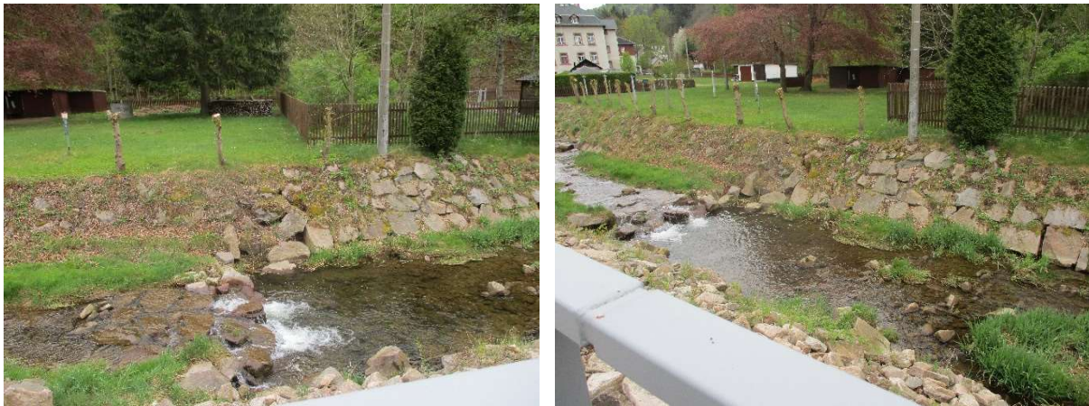
Bilder 11 und 12: Rote Weißeritz bei Altenberger Straße 6 (Schaden 2001496)
