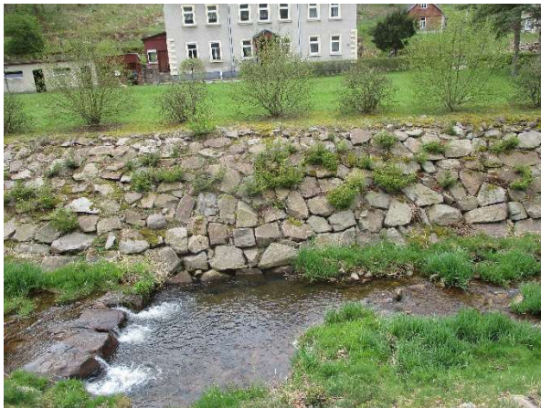
Bild 5: Schädelle bei Brücke Steinweg 6 (Schaden 2001510)
