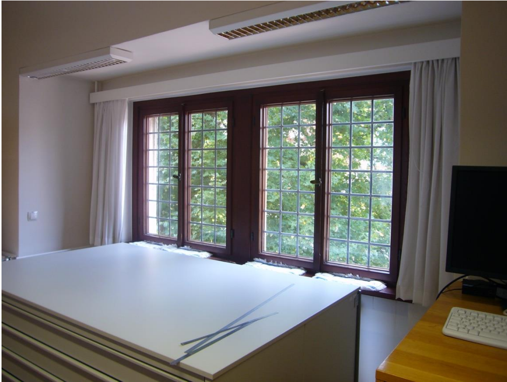
Halle, Kunstmuseum Moritzburg (Grafikdepot), behelfsmässige Abdichtung von Fenstern bei Starkregen
