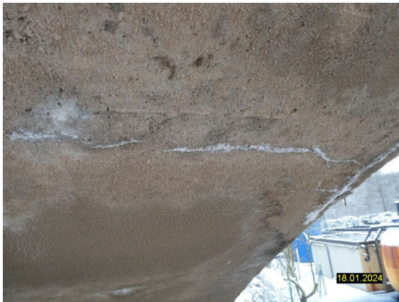
H2023_ÜBERBAU UNTERSEITIGER QUERRISS
