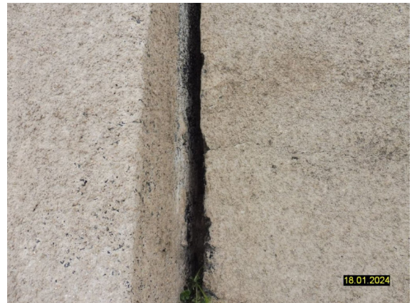
H2023_KÄMPFERGELENK FUGENFÜLLUNG HERAUSGEFALLEN
