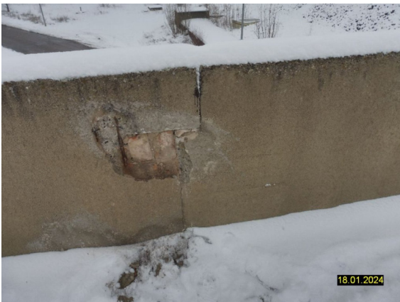
H2023_BRÜSTUNG PUTZ HOHLKLINGEND ABGEPLATZT_INNENSEITE
