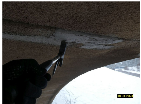
H2023_ÜBERBAU BETONINSTANDSETZUNG HOHLKLINGEND
