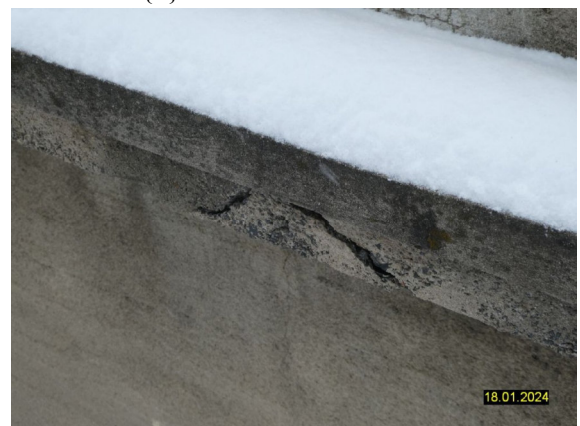
H2023_KAPPENGESIMS LOCKERE BETONTEILE
