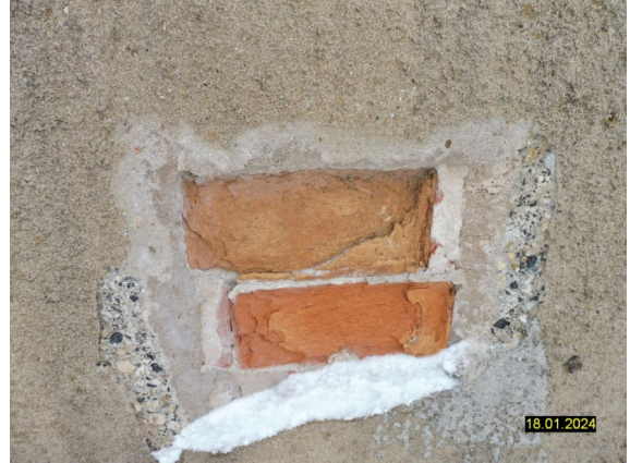
H2023_BRÜSTUNG ZIEGELMAUERWERK ZERFÄLLT
