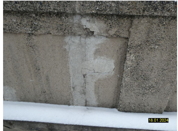
H2023_BRÜSTUNG PUTZ HOHLKLINGEND ABGEPLATZT_AUSSENSEITE
