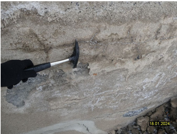
H2023_FLÜGEL ABPLATZUNG UND HOHLKLINGEND
