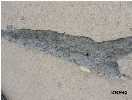
H2023_FLÜGEL BETON ZERFÄLLT
