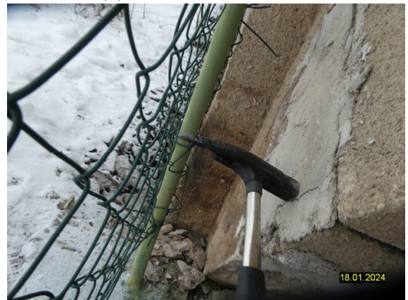
H2023_KÄMPFER BETONINSTANDSETZUNG HOHLKLINGEND
