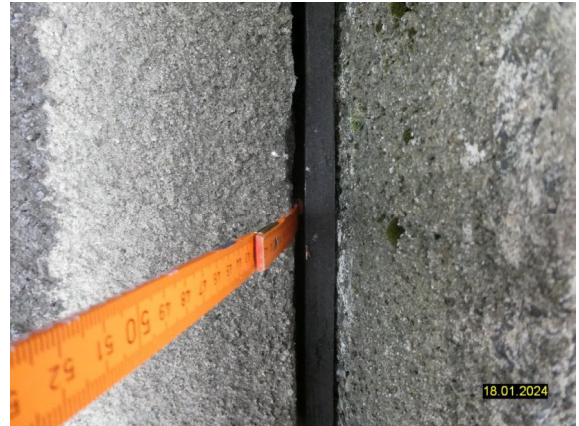
H2023_KÄMPFERGELENK FUGENVERFORMUNG BEHINDERT
