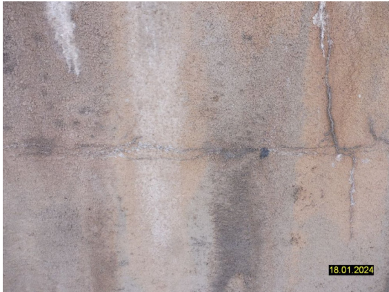
H2023_WIDERLAGER QUERRISS MIT AUSSINTERUNGEN
