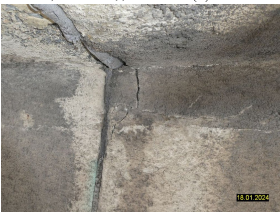
H2023_STIRNWAND LÄNGSRISSE IM BEREICH DES KÄMPFERGELENKES
