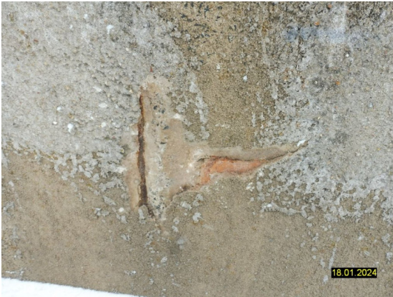
H2023_BRÜSTUNG FREILIEGENDE KORRODIERTE BEWEHRUNG
