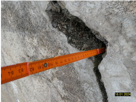
H2023_FLÜGEL 2 M HINTER GENLENK VOLLSTÄNDIG ABGERISSEN
