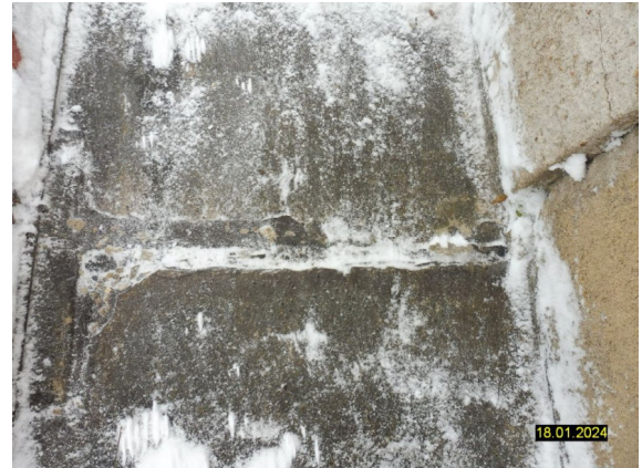
H2023_RANDWEG FUGENFÜLLUNG GERISSEN
