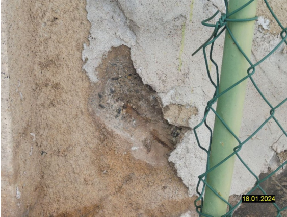
H2023_FLÜGEL FREILIEGEBDE KORRODIERTE BEWEHRUNG
