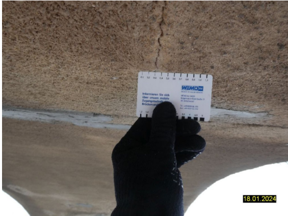
H2023_ÜBERBAU UNTERSEITIGER LÄNGSRISS
