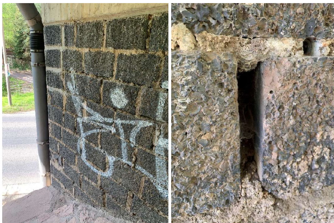
Bild 12: vordere erste Pfeiler, schadhafte Mauerwerksfugen (Stand: 05.2024)
