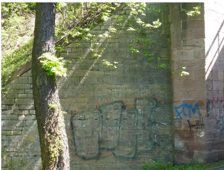
Bild 14: angrenzende Altunterbauten, Mauerwerk schadhaft (Stand: 05.2024)
