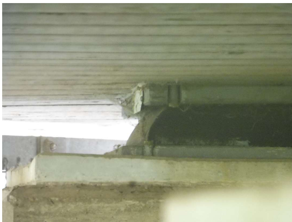
Bild 10: Elastomerlager stark verformt (Stand: 05.2024)
