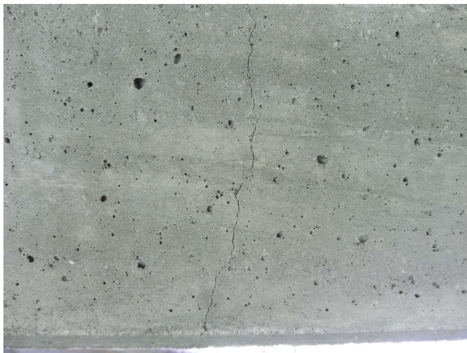
Bild 9: Querrisse im Überbau (Stand: 05.2024)
