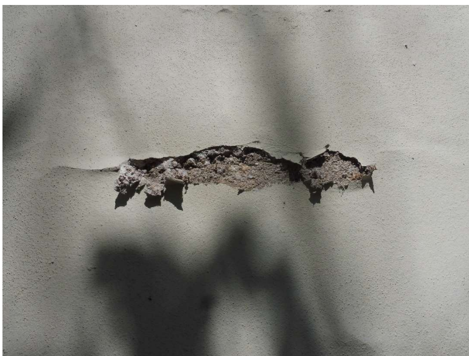
Bild 13: hintere zweite Pfeiler, Oberflächenschutzsystem schadhaft (Stand: 05.2024)
