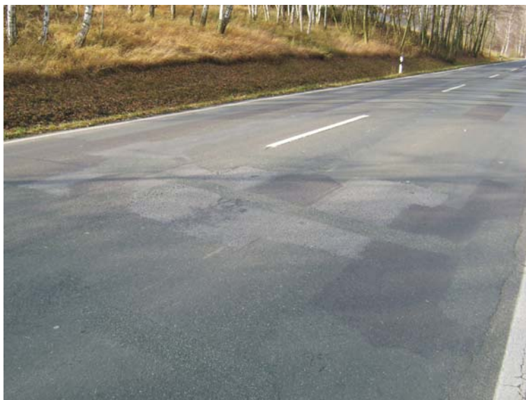
Foto Nr. 4 (km 1+250 - Flickstellen, Unebenheiten)
