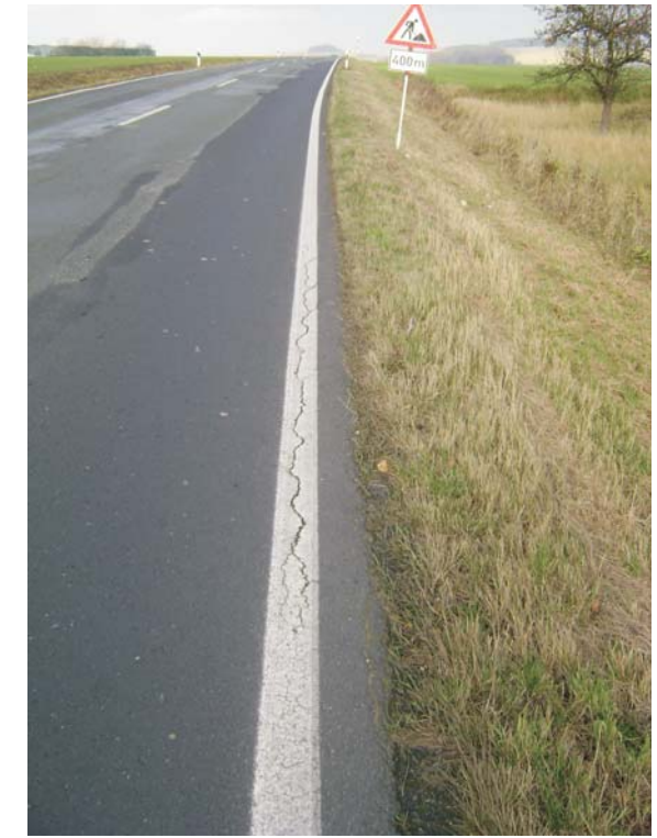
Foto Nr. 3 (km 0+320 - Rissbildungen)
