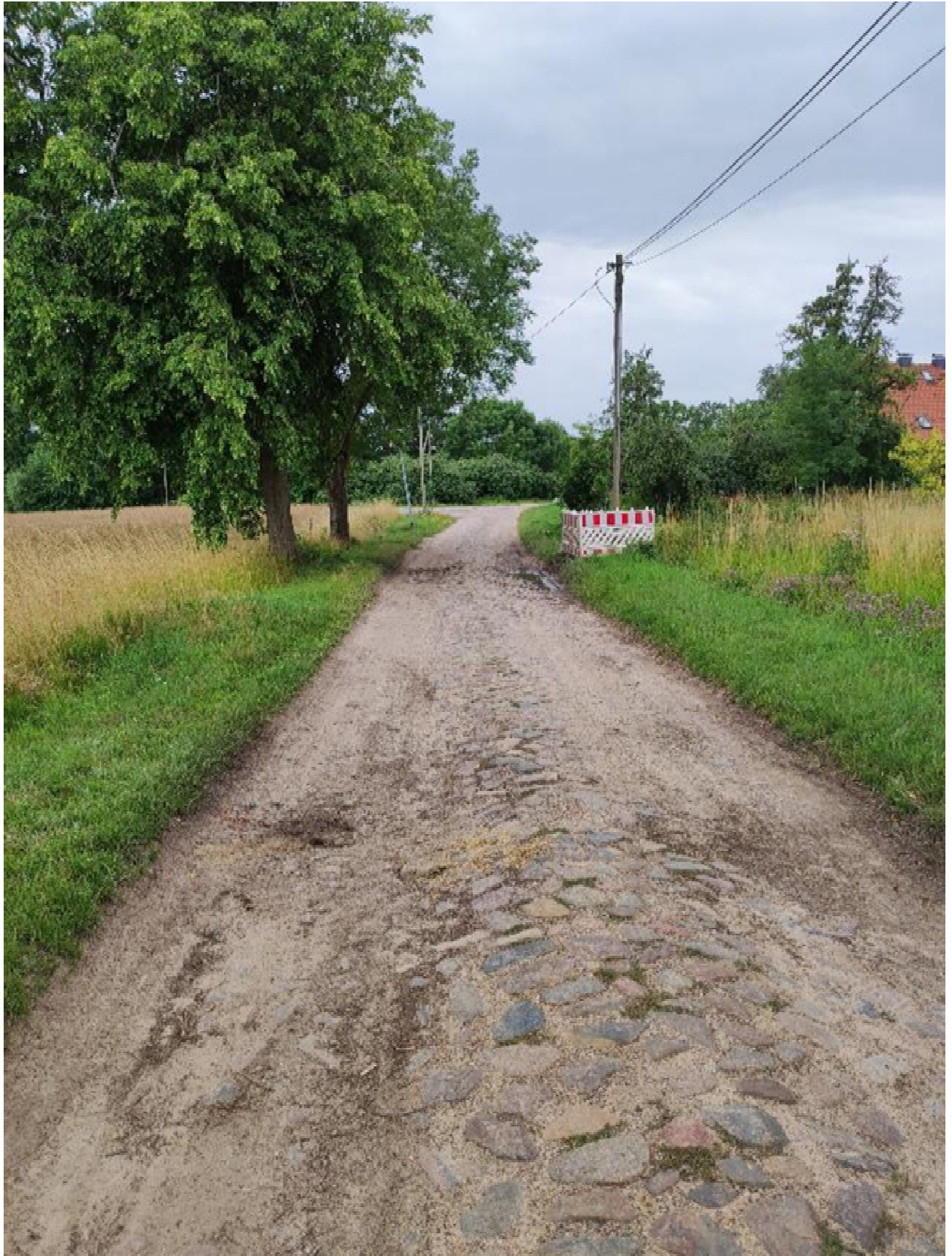
Foto 4: Der Zustand der Straße ist nicht zeitgemäß.
