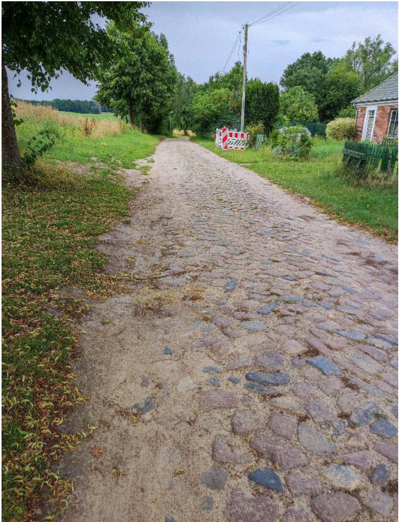
Foto 3: Die Straße liegt allgemein niedriger als die angrenzenden Gehöfte
