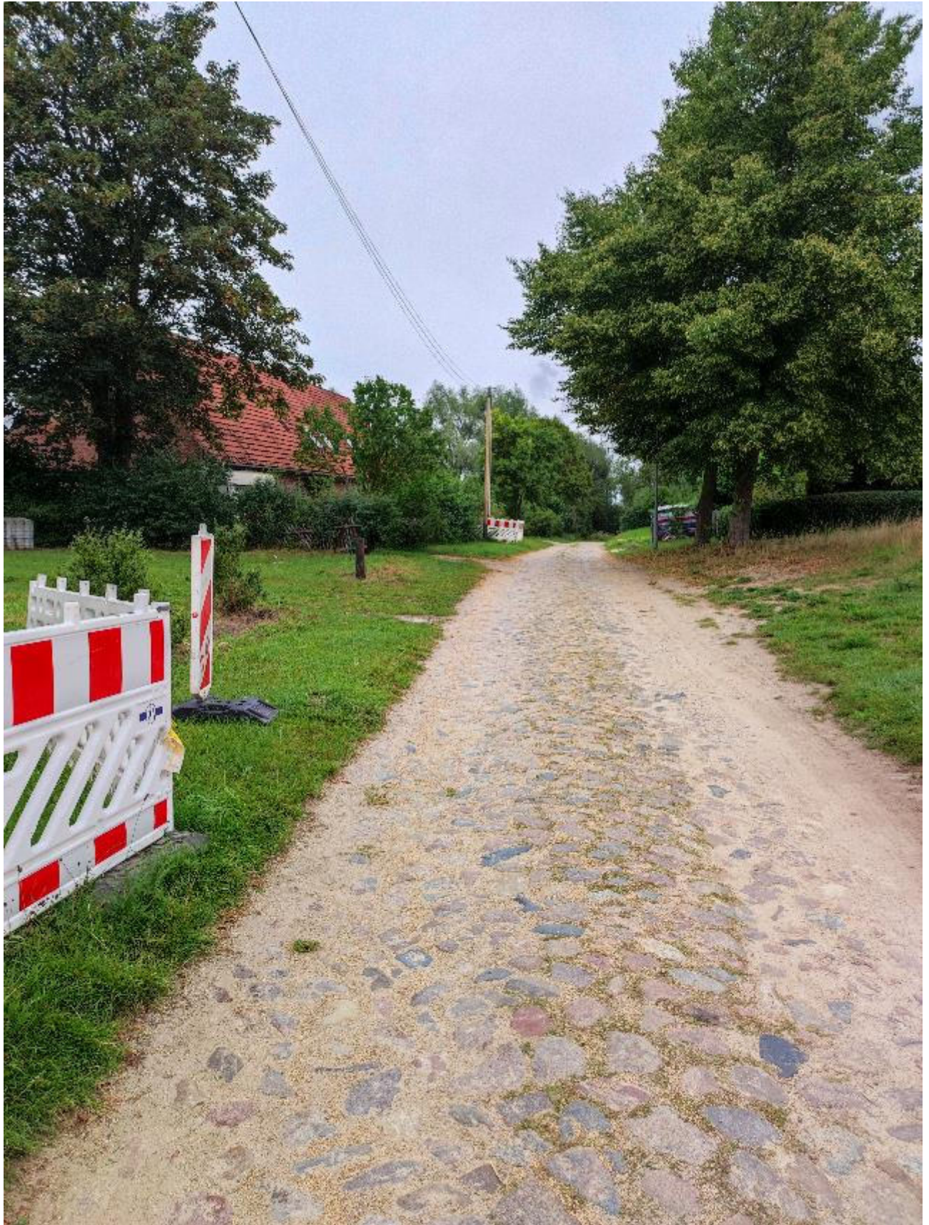
Foto 5: Die Fahrspuren in der Pflasterstraße sind nach unten verdrückt.
