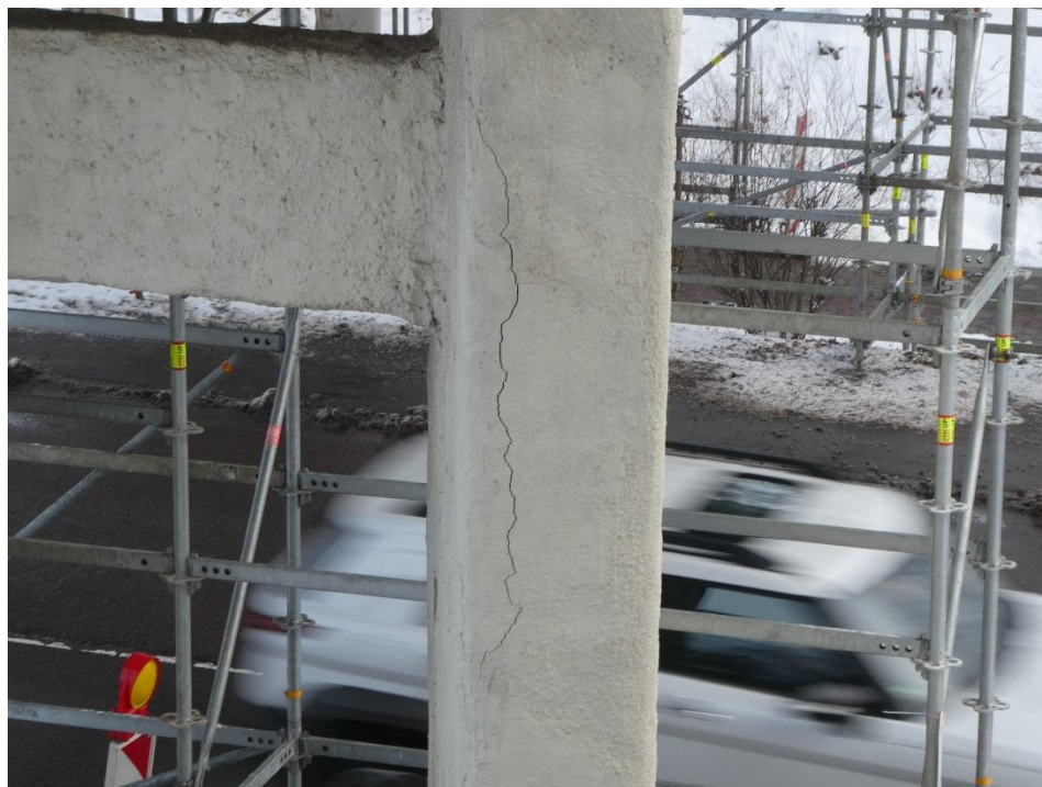
Bild 9: Betonschäden (Betonersatzsystem) am Pfeiler (Stand: 01.2024)
