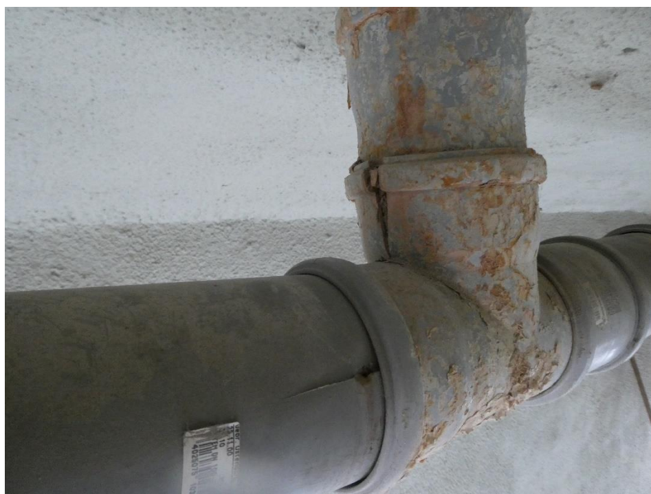
Bild 7: schadhafte Entwässerung (Stand: 01.2024)
