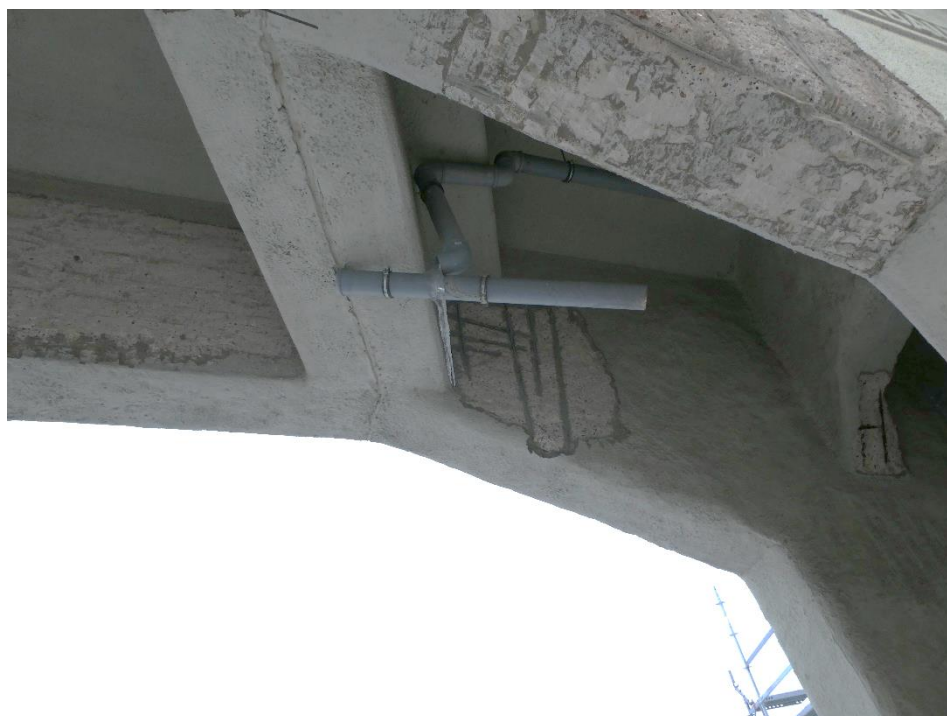
Bild 8: schadhafte Entwässerung (Stand: 01.2024)
