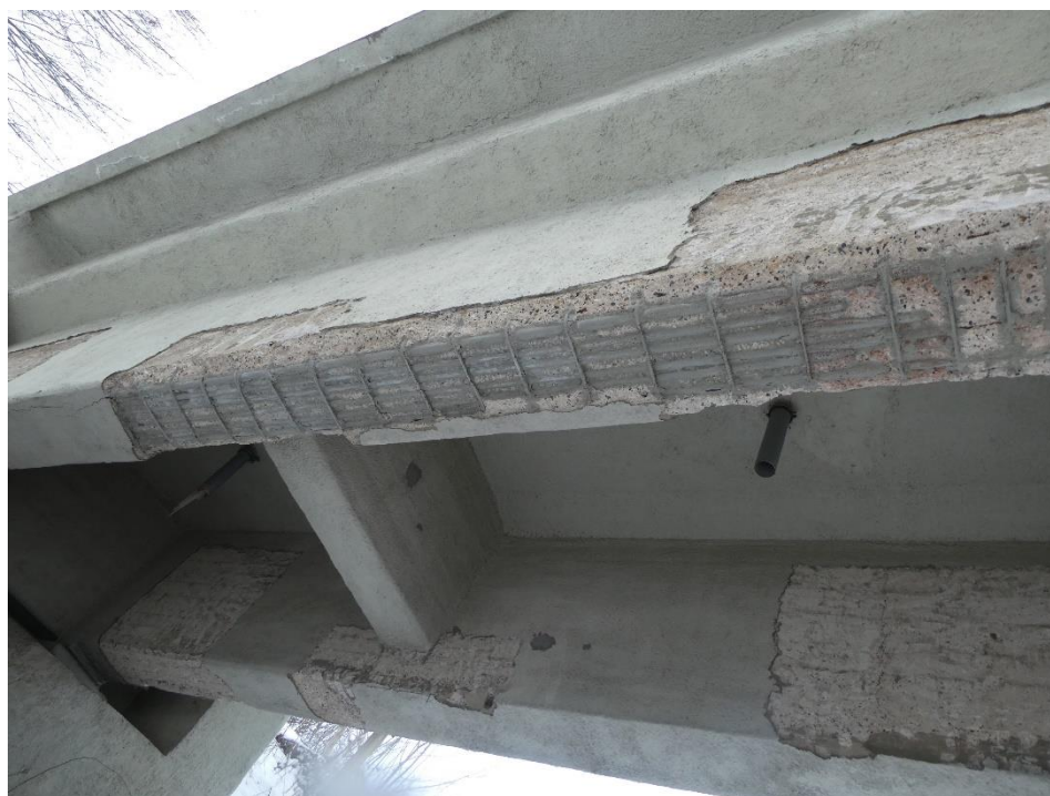
Bild 6: Betonschäden (Bestandsbeton und Betonersatzsystem) unterseitig am Hauptträger (Stand: 01.2024)
