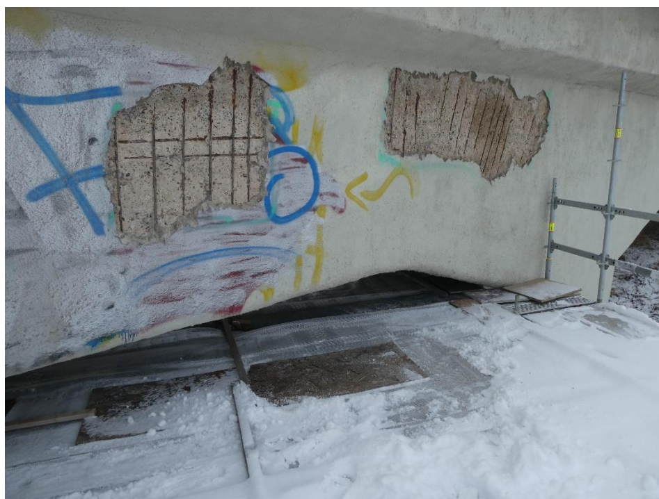
Bild 5: Betonschäden (Bestandsbeton und Betonersatzsystem) seitlich am Hauptträger (Stand: 01.2024)
