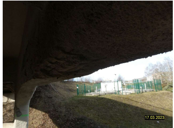
S2023_LÄNGSTRÄGER SPRITZBETON ABGESCHLAGEN_FREILIEGENDE BW_NORDWEST FELD 2
