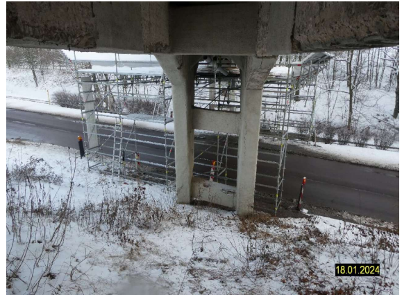
S2024_LÄNGSTRÄGER SPRITZBETON ABGESCHLAGEN_FREILIEGENDE BW_FELD 3
