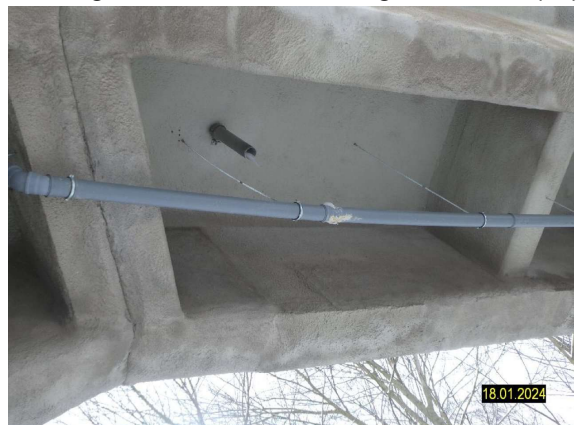
S2024_EW-LEITUNG ERNEUT SCHADHAFT_FELD 1
