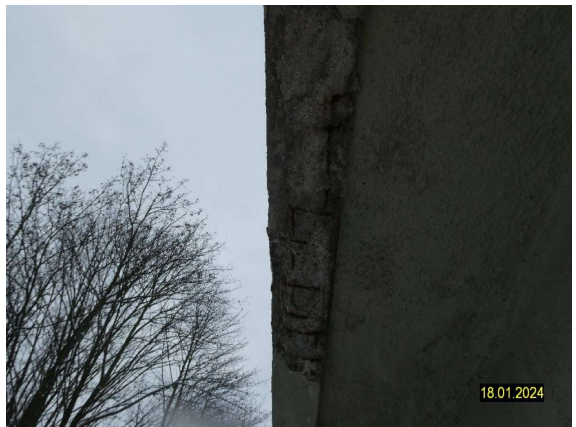
S2024_KAPPE SPRITZBETON ABGEPLATZT_FREILIEGENDE BW_SÜD
