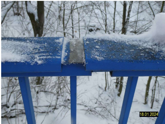
S2024_GELÄNDER DEHNSTOSS KORR-SCHUTZ FEHLT
