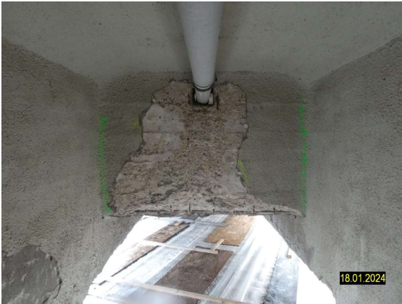
S2024_QUERSCHOTT SPRITZBETON ABGESCHLAGEN_FREILIEGENDE BW-FELD 2
