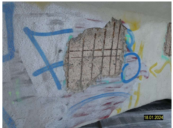
S2024_LÄNGSTRÄGER SPRITZBETON ABGEPLATZT_FREILIEGENDE BW_WEST FELD 2
