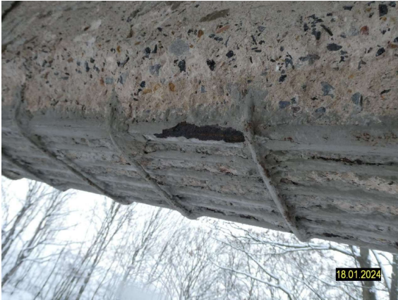
S2024_LÄNGSTRÄGER SPRITZBETON ABGESCHLAGEN_FREILIEGENDE BW_SÜD FELD 3
