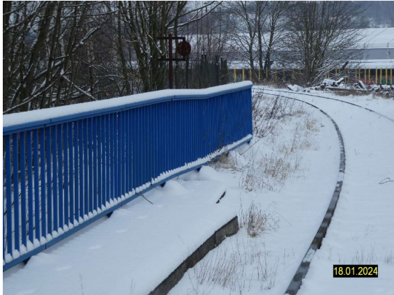
S2024_GELÄNDER ANSCHLUSSBEREICH ABGESACKT
