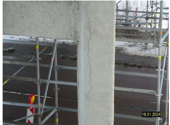
S2024_PFEILER 2 SPRITZBETON GERISSEN_HOHLSTELLE_NORD
