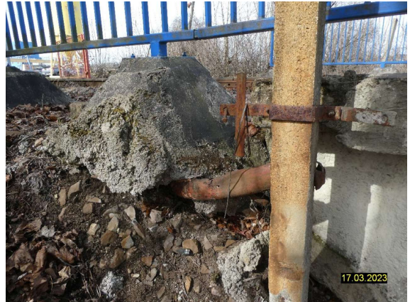
S2023_GELÄNDER FUNDAMENTE HOHLLIEGEND
