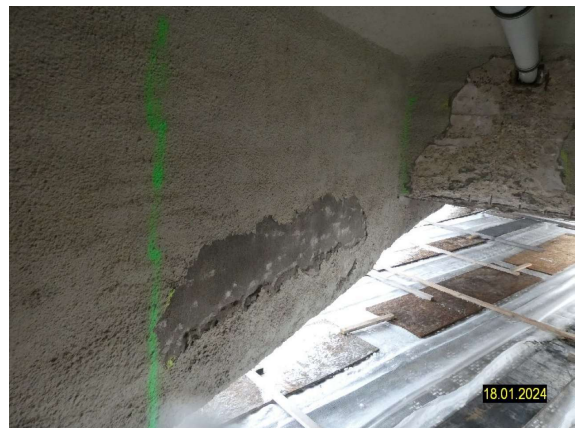
S2024_LÄNGSTRÄGER SPRITZBETON ABGESCHLAGEN_NORD FELD 2
