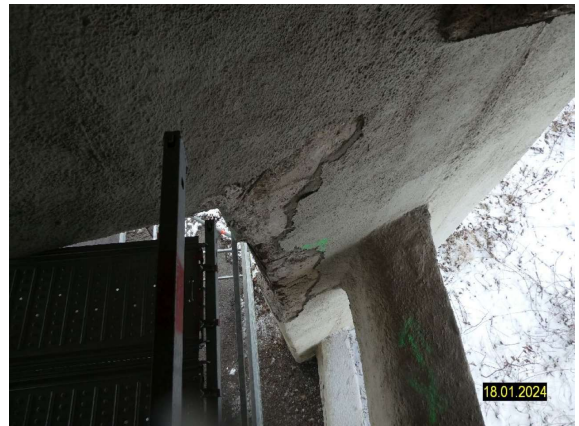
S2024_PFEILER 2 SPRITZBETON ABGESCHLAGEN_FREILIEGENDE BW_SÜD
