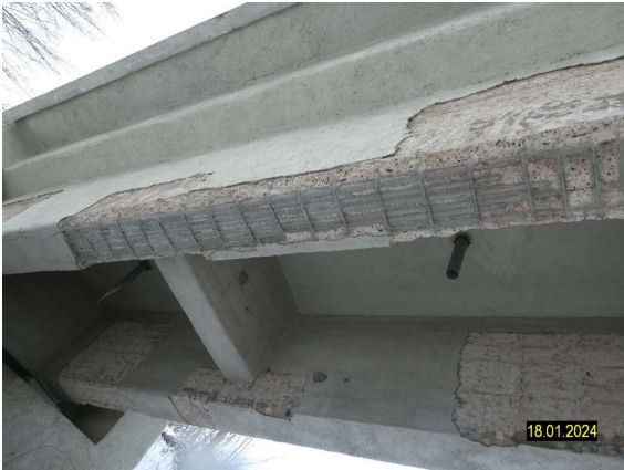
S2024_LÄNGSTRÄGER SPRITZBETON ABGESCHLAGEN_FREILIEGENDE BW_SÜD FELD 3_1
