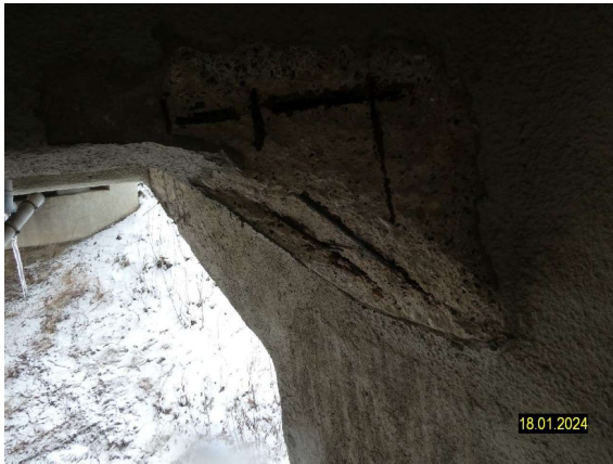
S2024_PFEILER 2 SPRITZBETON ABGESCHLAGEN_FREILIEGENDE BW_OBEN
