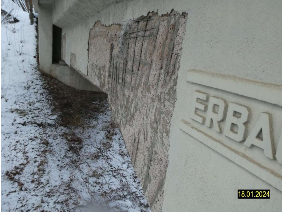
S2024_LÄNGSTRÄGER SPRITZBETON ABGESCHLAGEN_FREILIEGENDE BW_ÜBER PFEILER 2_SÜD
