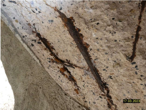
S2023_PFEILER 2 SPRITZBETON ABGESCHLAGEN_FREILIEGENDE BW_OBEN
