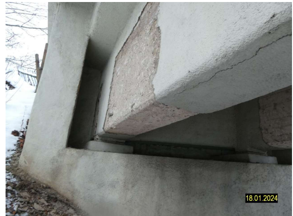
S2024_LÄNGSTRÄGER SPRITZBETON ABGESCHLAGEN_FREILIEGENDE BW_SÜD INNEN_AUSSEN FELD 3
