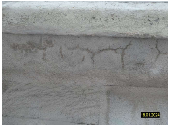
S2024_LÄNGSTRÄGER AUSKRAGUNG SPRITZMÖRTELAUFTRAG_NETZRISSE MIT AUSSINTERUNG_SÜD FELD 2
