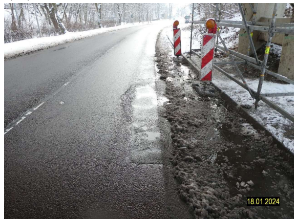
S2024_FAHRBAHNBELAG TROPFWASSERSCHADEN_UNTER BW
