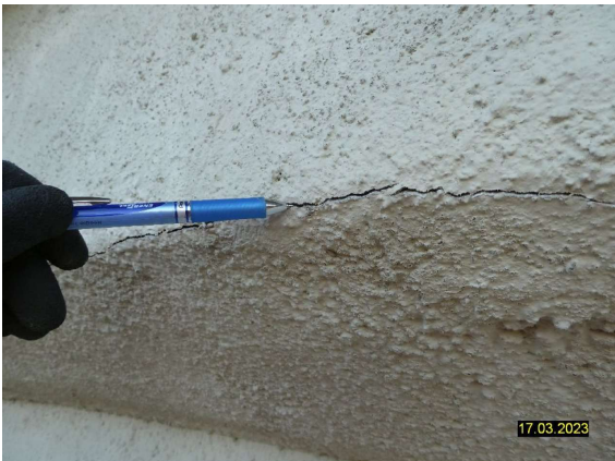
S2023_LÄNGSTRÄGER AUSKRAGUNG SPRITZBETON GERISSEN_HOHLKLINGEND_FELD 2
