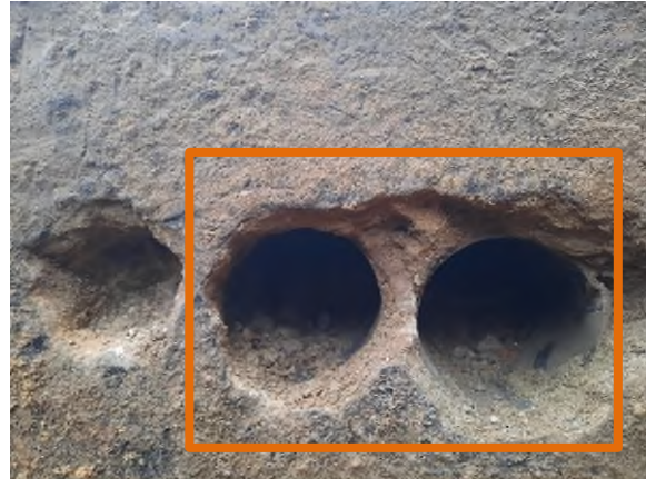
Abbildung 14: Frontalansicht der Leerrohre in der Pfaffendorfer Brücke (Ostseite)
