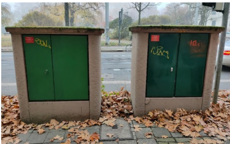
Abbildung 11: Frontansicht des RV503 (links) und KV309 (rechts) am Nordplatz
