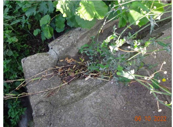
S25 RINNE SCHADHAFT
