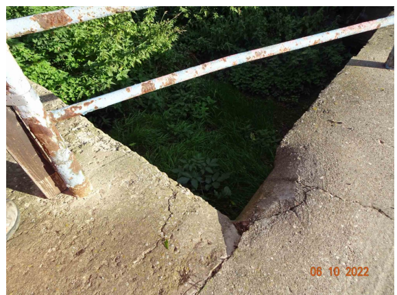
S2 LAGE DES GELÄNDERS FALSCH
