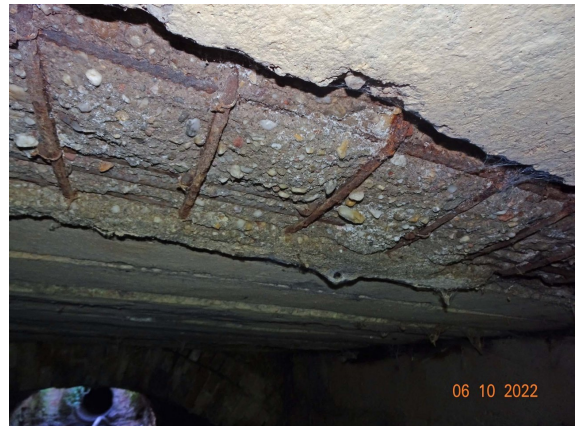
S19 VERROSTETE BEWHRUNG AN BETONFERTIGTEIL
