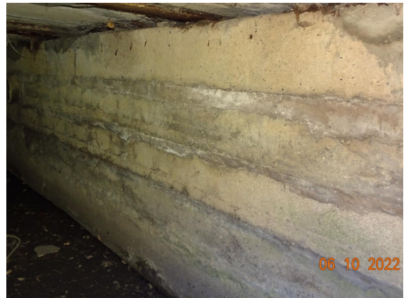
S18 WDL VORN FUGEN HOHLKLINGEND
