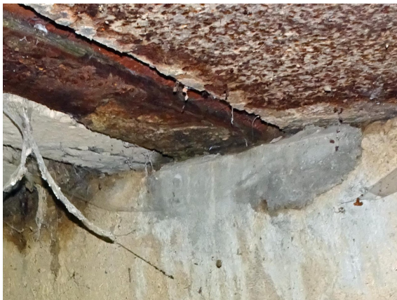
S20 TRÄGERUNTERSEITE VERROSTET
