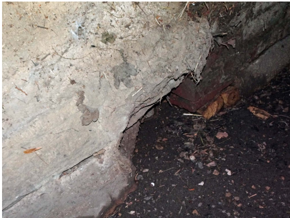
S28 WDL HINTEN STEINE HERAUSGEBROCHEN
