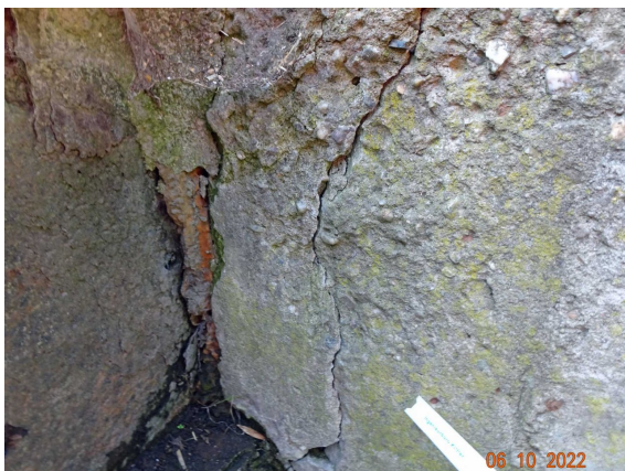
S27 STÜTZWAND VORN GERISSEN
