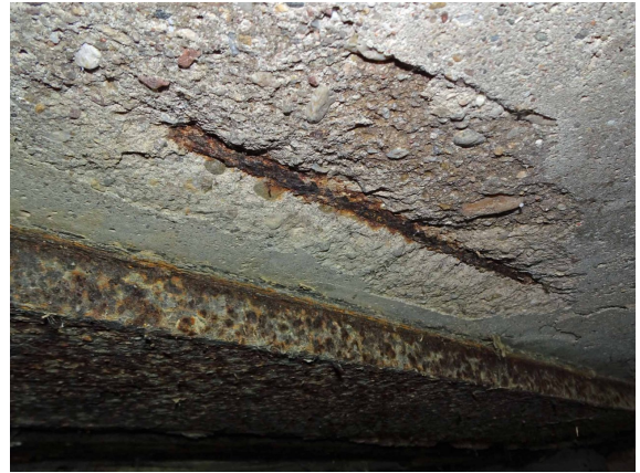
S14 FREILIEGENDE BEWHRUNG AN FÜLLBETON
