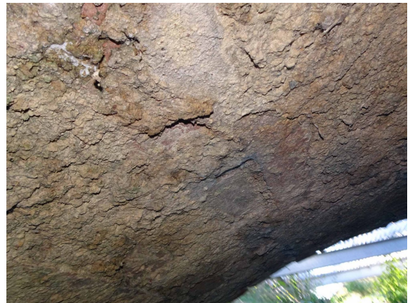
S31 SPRITZBETONSCHALE ABGEPLATZT
