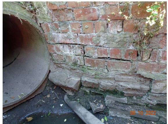
S14 STÜTZWAND UNTERSPIILT
