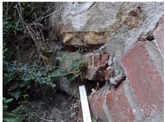
S18 STIRNWAND FUGENAUSGEBROCHEN VORN
