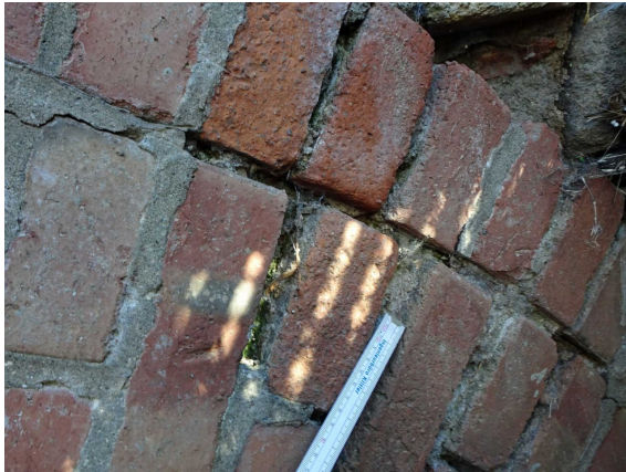
S20 STIRNRING FUGENMÖRTEL HERAUSGEBROCHEN
