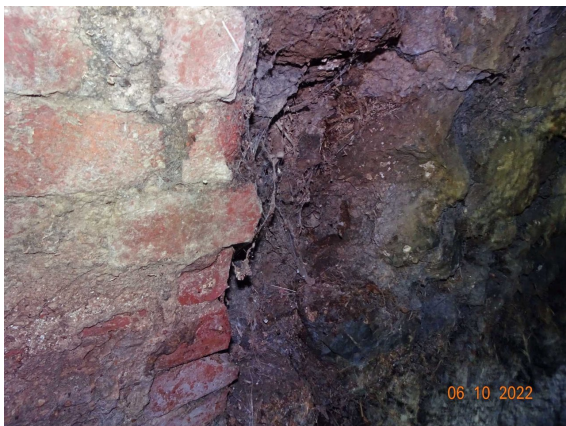
S33 STEINE AN WANDUNG HERAUSGEBROCHEN
