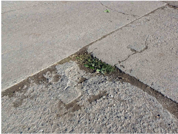
S17 AUSBRÜCHE IM BELAG
