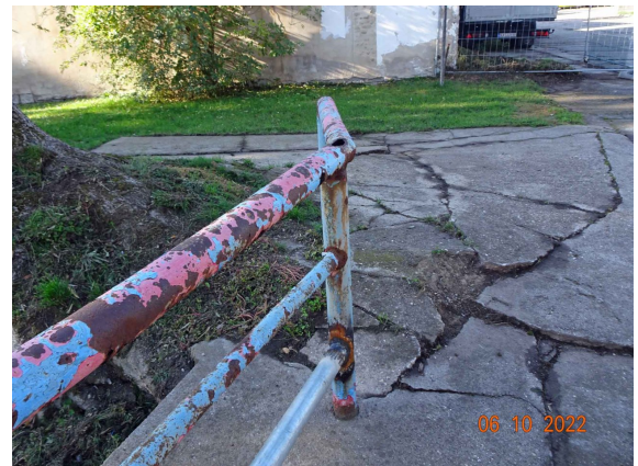
S16 BELAG DURCH WURZEL HOCHGEDRÜCKT
