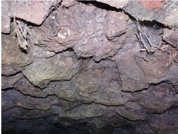
S19 MAUERWERKSFUGEN SCHADHAFT
