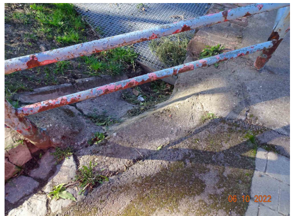
S28 LAGE DES GELÄNDERS FALSCH
