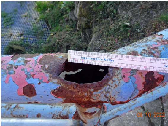
S3 GELÄNDER DURCHGEROSTET
