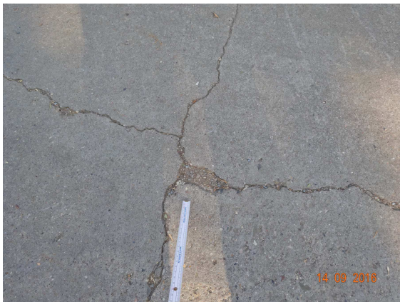
S08 AUSGEPRÄGTE RISSE IN DER FAHRBAHN
