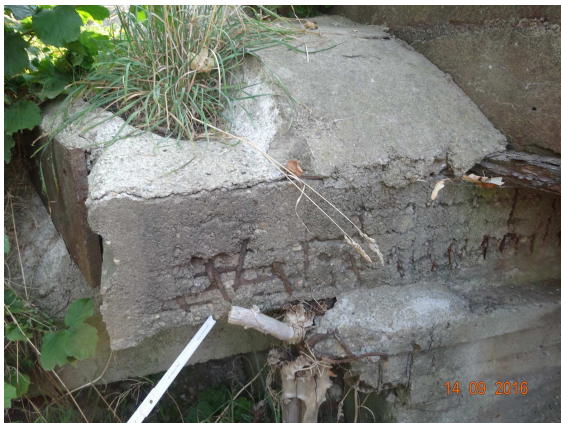
S13 FREILIEGENDE BEWEHRUNG IN WIDERLAGERWAND
