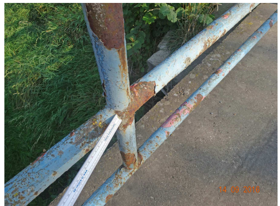
S03 GROßFLÄCHIG FEHLENDE BESCHICHTUNG DARUNTER ROST
