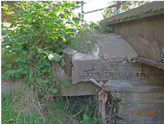
S25 ENTWÄSSERUNGSRINNE HINTERES WDL ZU KURZ
