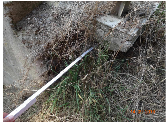
S11 STÜTZWAND VORN LINKS LIEGT HOHL
