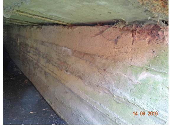
S15 FREILIEGENDE BEWEHRUNG IN WDL LINKS
