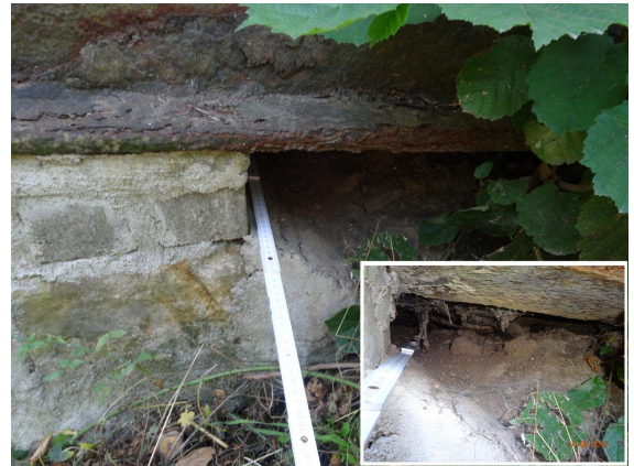
S21 FEHLENDE HINTERFÜLLUNG
