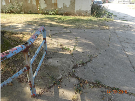
S16 FAHRBAHNBELAG ANGEHOBEN UND GERISSEN
