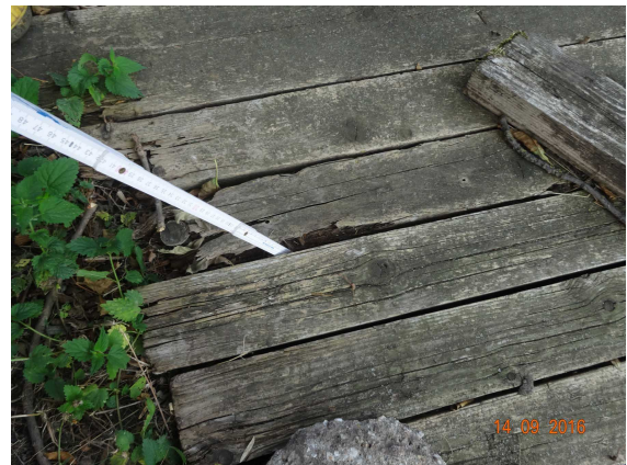
S24 ABDECKUNG DES SCHACHTS ANGEFAULT
