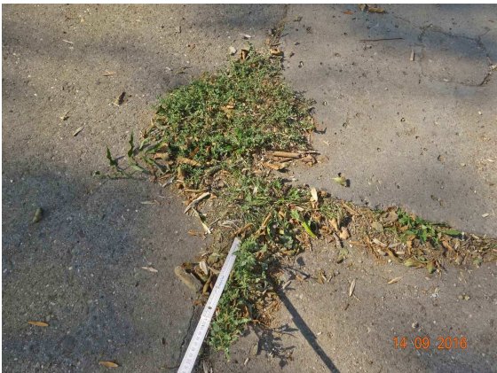
S17 GROßFLÄCHIGE AUSBRUCHE UND RISSE
