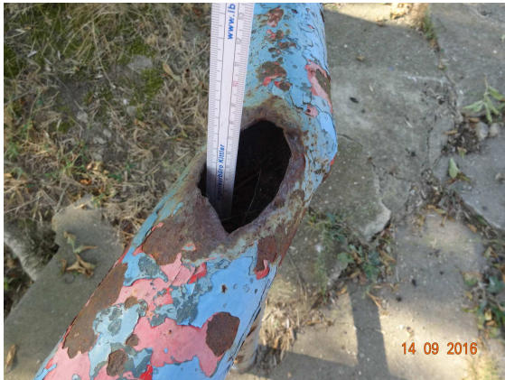
S03 STARKE KORROSION DES GELÄNDERS
