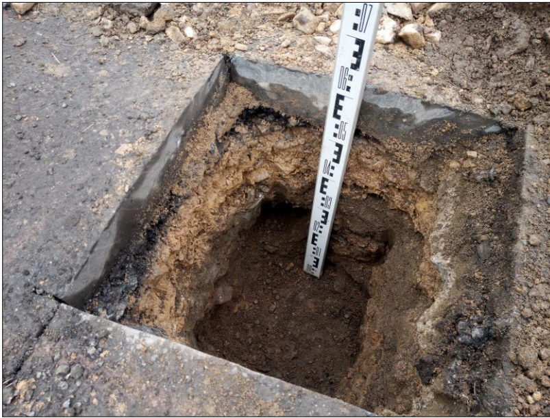
Bild 13: Vertiefter Schurf bis auf -0,60 m unter Fahrbahnoberkante (FOK) mit groben Steinen und Blöcken auf der Sohle (Kantenlängen >20 cm), Foto: GIAB, 21.02.2024
