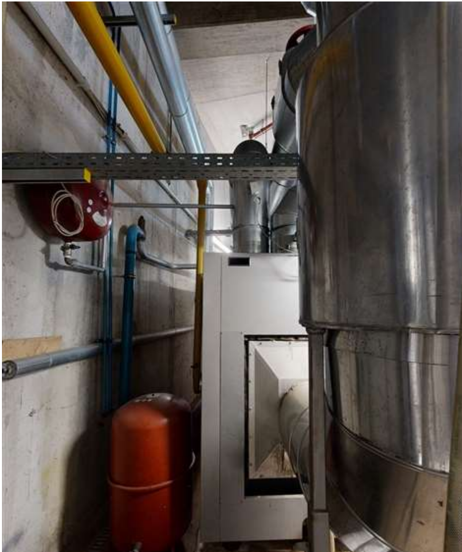
Bild 3: Gasanschluss, Kessel rechts
