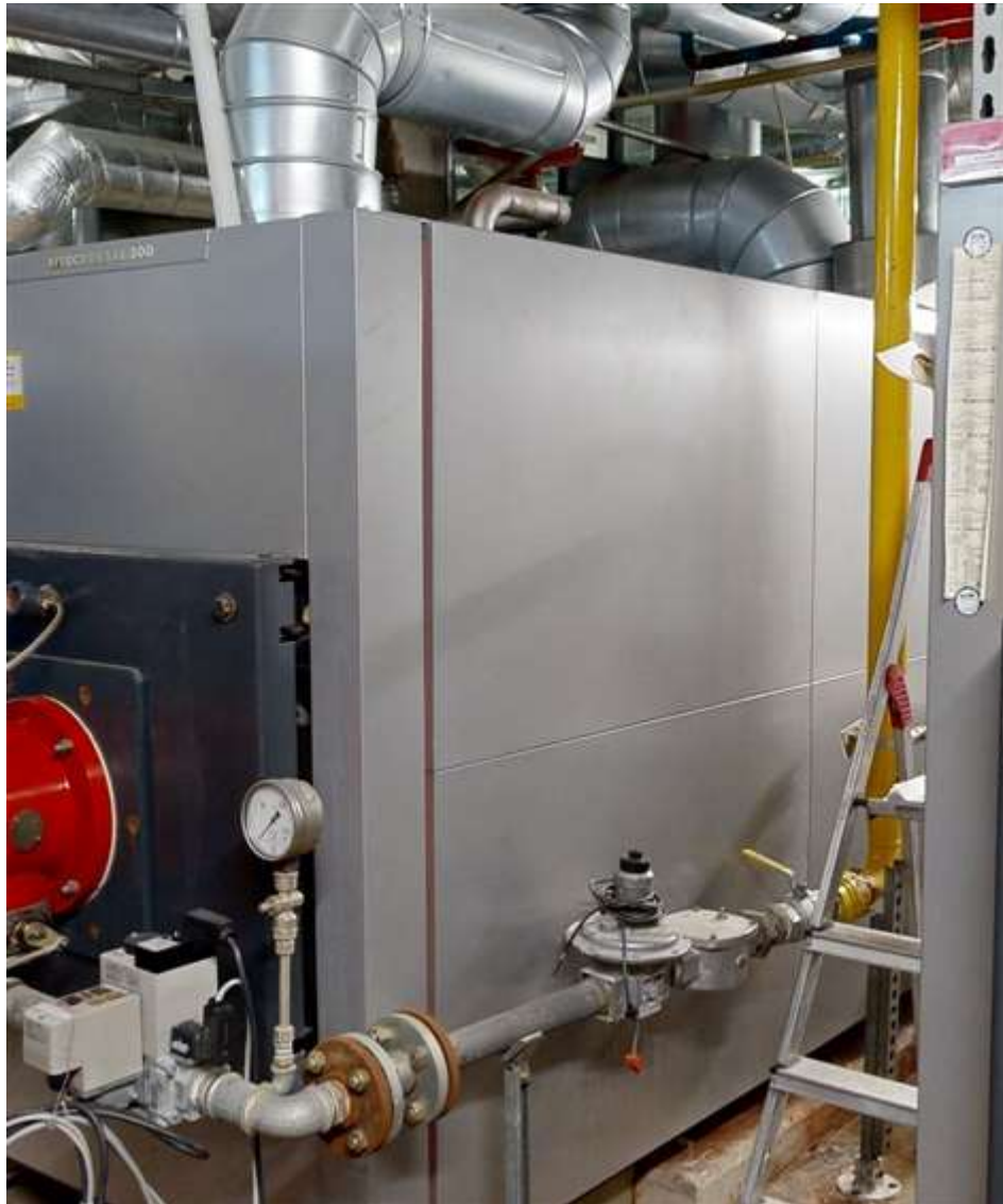
Bild 2: Gasanschluss, Kessel links
