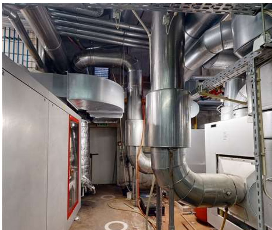
Bild 3: Abgasleitungen der Kessel Der Zugang erfolgt über den Montageschacht und die Türdurchführung ist durch das BHKW etwas reduziert.
