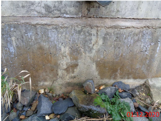
2020E_027_OBERFLÄCHE BQ-STEINE RISSIG
