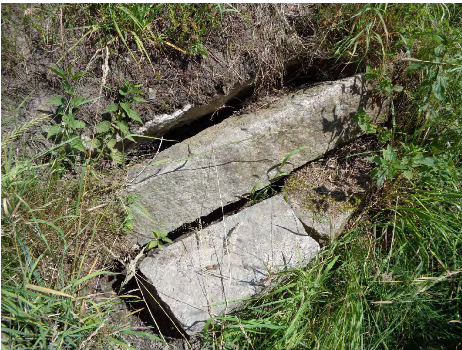
06_Detailansicht verbrochener Zulaufbereich linker Fahrbahnrand
