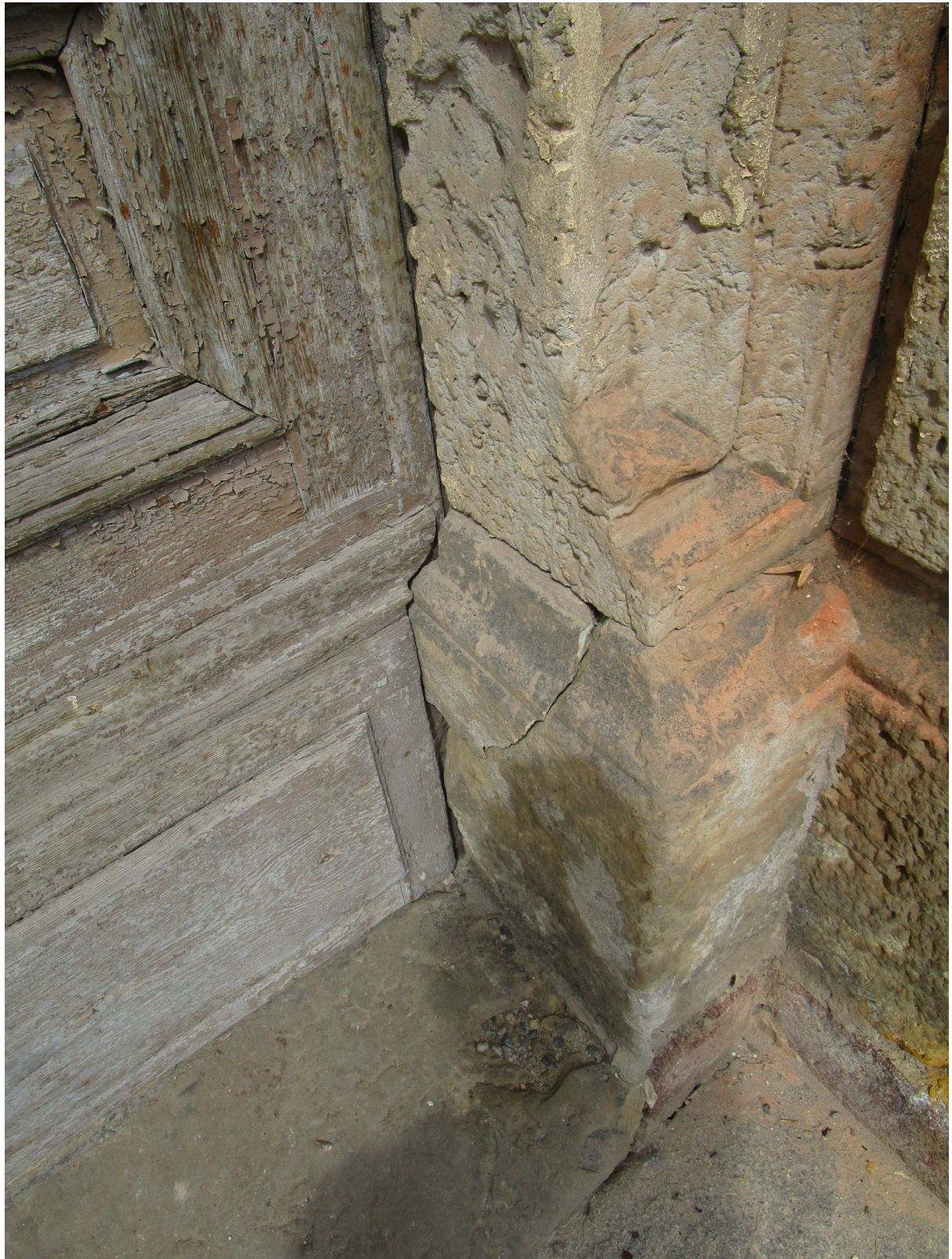
Fassade hofseitig – Schäden Natursteintürgewände Mittelrisalit
