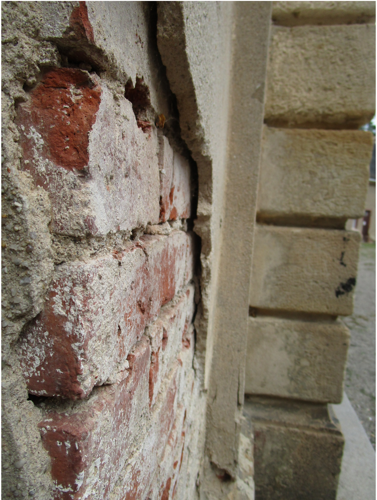
Fassade hofseitig – Putzhohlage
