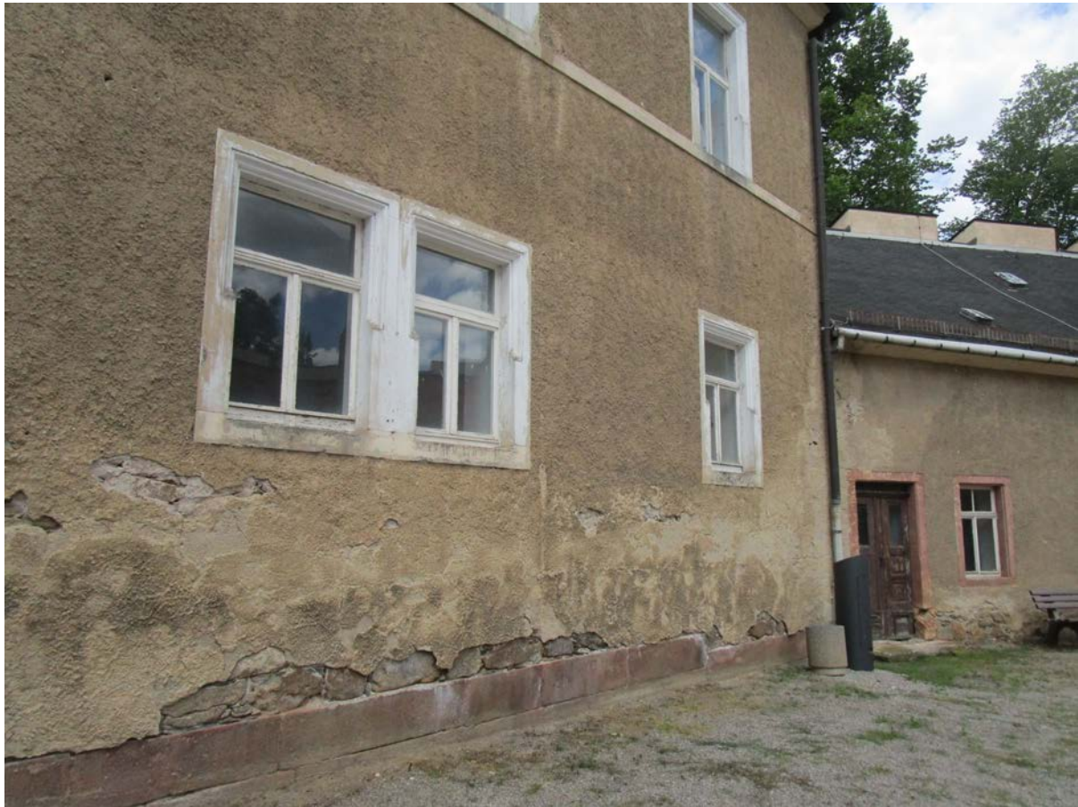
Fassade hofseitig – Feuchte- und Salzschädigungen
