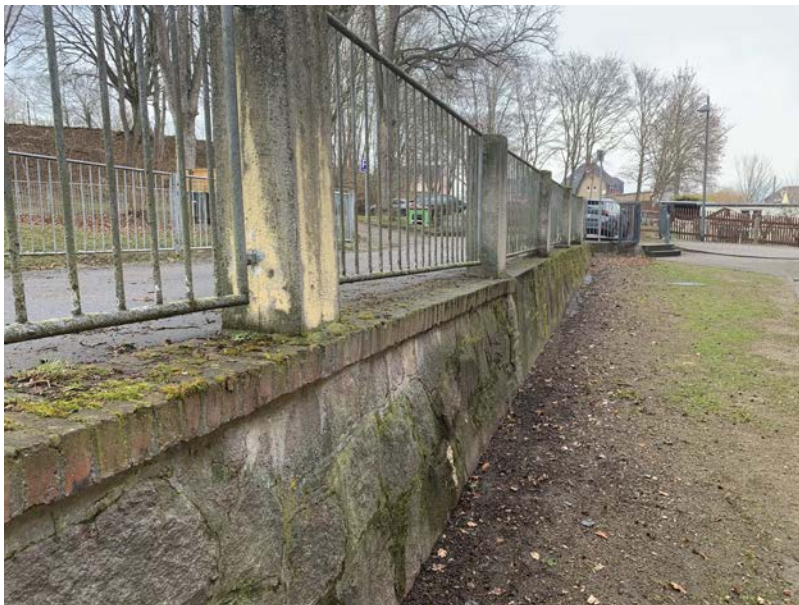
HP 2021-BILD 11-STW NATURSTEINE BWM OFFENE FUGEN DURCHFUCHTUNG AUSBLÜHUNGEN
