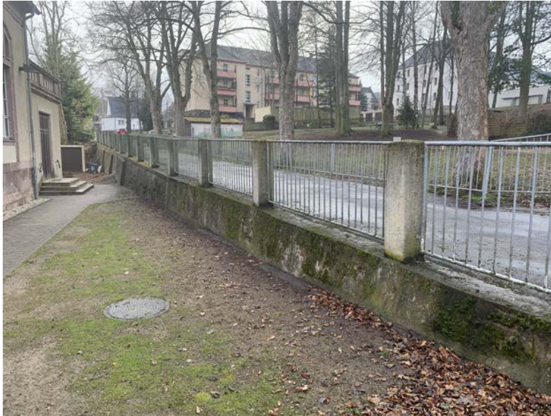
HP 2021-BILD 10-BWE STW BETON GERISSEN WASSERAUSTRITT BEWUCHS
