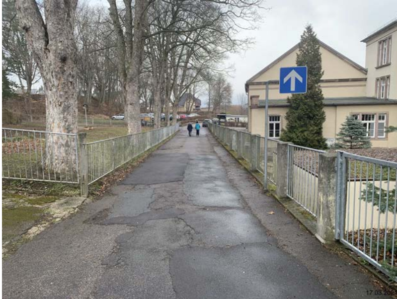
HP 2021-BILD 08-FAHRBAHNBELAG AM BWA BELAG AUSBRÜCHE RISSE
