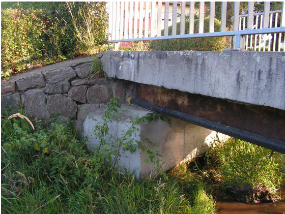
2020H_09_TEMP SICHERUNG BEHINDERT ABFLUSS
