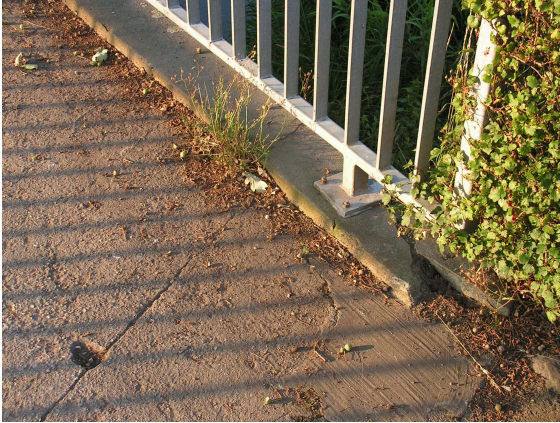
2020H_04_GESIMS OBERSTROM SCHADHAFT
