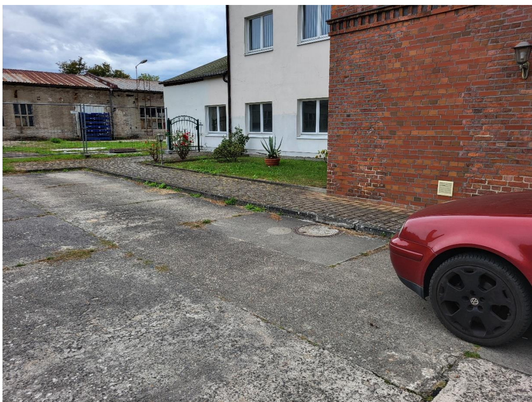
Bild 4: Betonfläche Einfahrt Straupitzstraße 11, Blickrichtung Nordost
