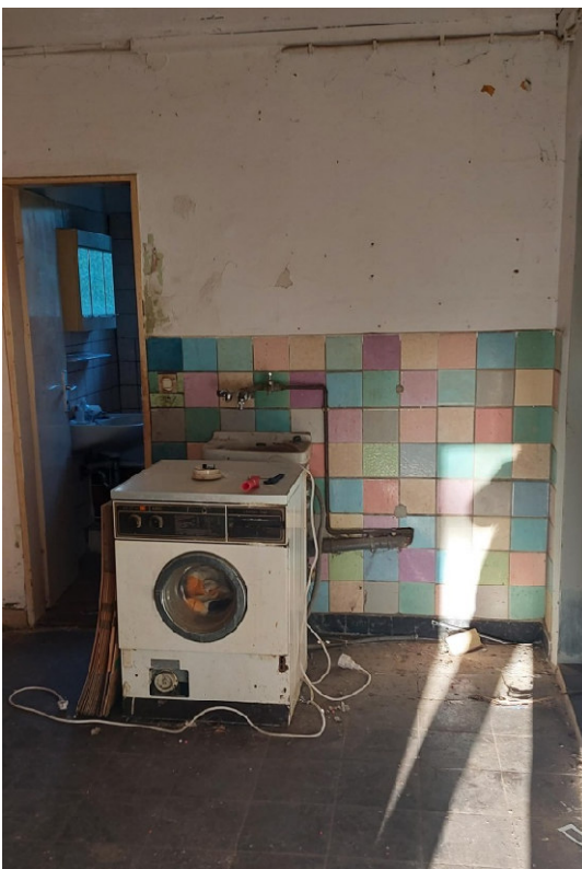
25. Lichtbild: Innenansicht Flur, im Obergeschoss, Haus 4. (Spülbecken im Flur)
