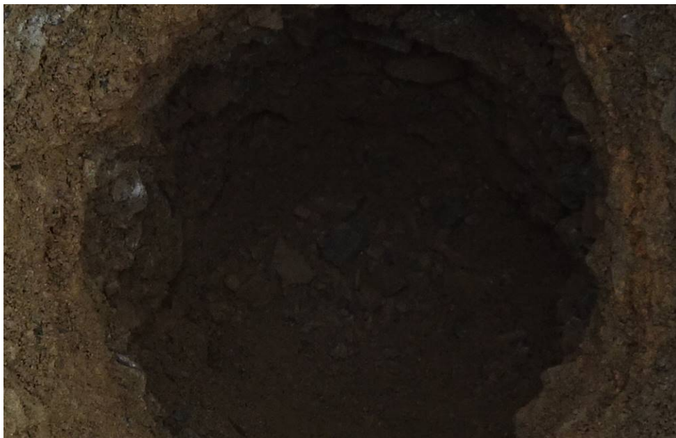
Bild 26: Entnahmestelle 8, Schurf S5 – FB Umstrukturierung Trinkwasserleitung Thallwitz – Lossatal 1. BA, Bereich Fahrbahn Blick in Schurf
