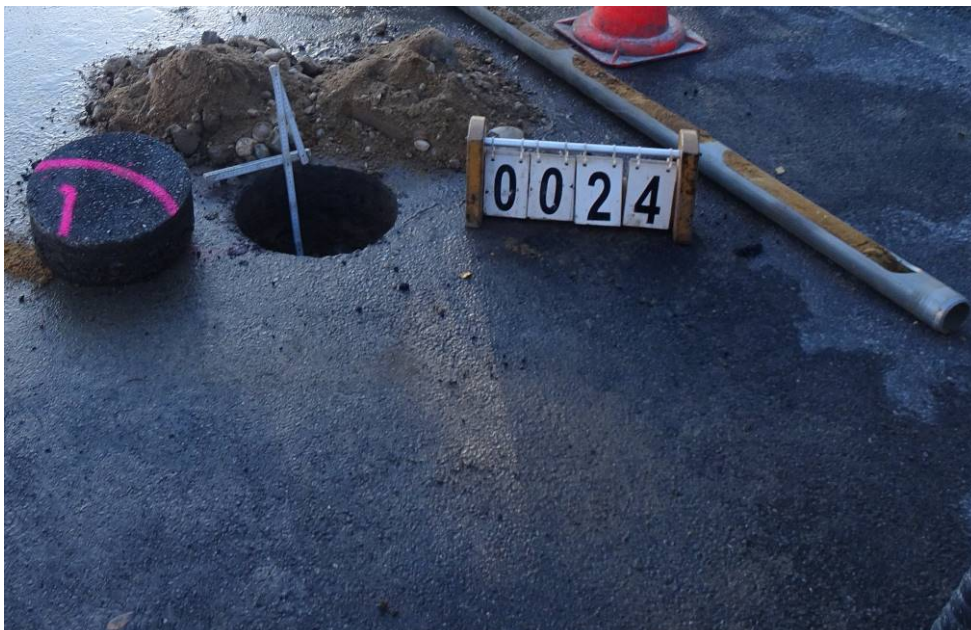
Bild 80: Entnahmestelle 24, Schurf S12 – FB / Rammkernsondierung RKS 17 Umstrukturierung Trinkwasserleitung Thallwitz – Lossatal 2. BA, Bereich Fahrbahn Material der einzelnen Schichten ausgebaut
