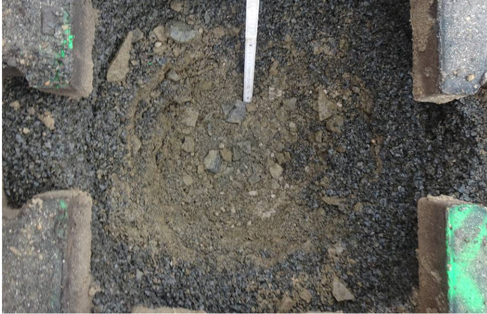
Bild 23: Entnahmestelle 7, Schurf S4 – GW Umstrukturierung Trinkwasserleitung Thallwitz – Lossatal 1. BA, Bereich Gehweg Blick in Schurf
