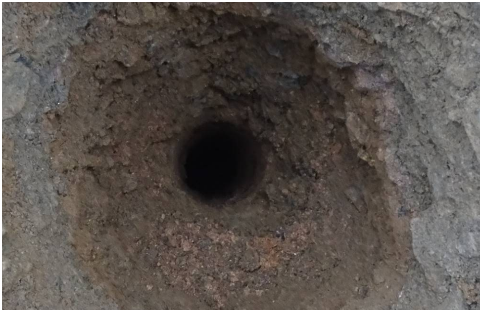
Bild 12: Entnahmestelle 4, Schurf S1 – FB / Rammkernsondierung RKS 4 Umstrukturierung Trinkwasserleitung Thallwitz – Lossatal 1. BA, Bereich Fahrbahn Blick in Sondierstelle
