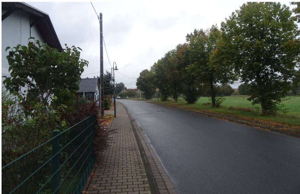
Bild 14: Entnahmestelle 5, Schurf S2 – GW Umstrukturierung Trinkwasserleitung Thallwitz – Lossatal 1. BA, Bereich Gehweg Übersicht
