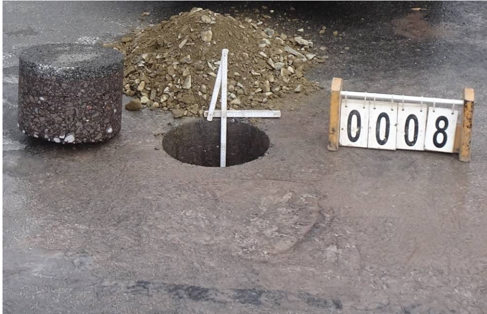
Bild 25: Entnahmestelle 8, Schurf S5 – FB Umstrukturierung Trinkwasserleitung Thallwitz – Lossatal 1. BA, Bereich Fahrbahn Material der einzelnen Schichten ausgebaut
