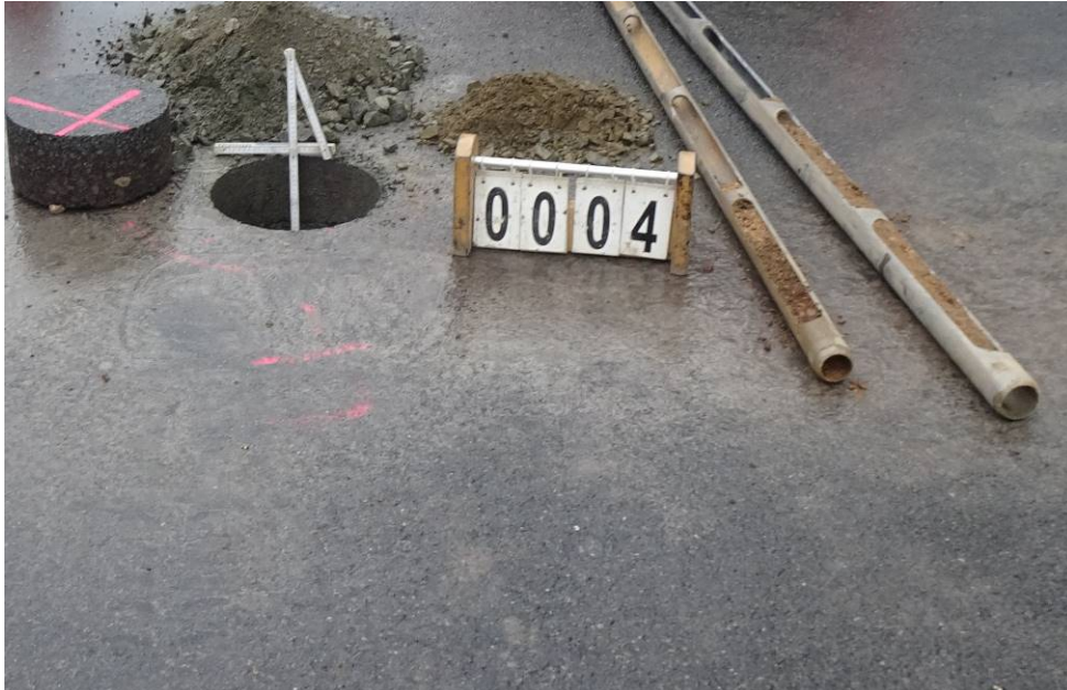
Bild 11: Entnahmestelle 4, Schurf S1 – FB / Rammkernsondierung RKS 4 Umstrukturierung Trinkwasserleitung Thallwitz – Lossatal 1. BA, Bereich Fahrbahn Material der einzelnen Schichten ausgebaut
