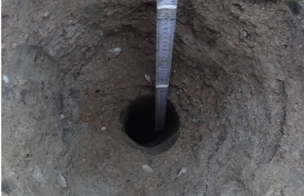
Bild 81: Entnahmestelle 24, Schurf S12 – FB / Rammkernsondierung RKS 17 Umstrukturierung Trinkwasserleitung Thallwitz – Lossatal 2. BA, Bereich Fahrbahn Blick in Sondierstelle
