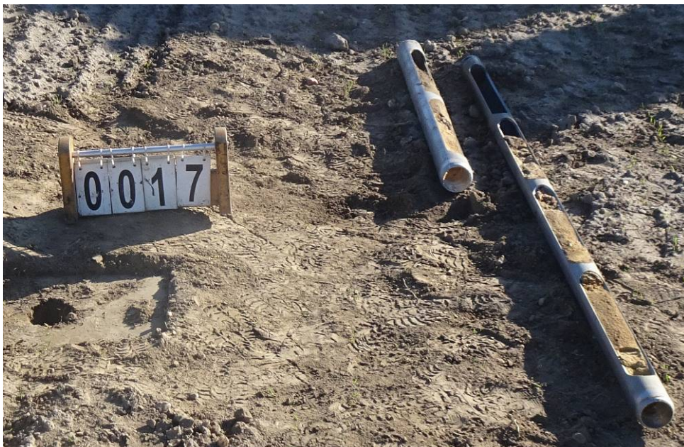
Bild 54: Entnahmestelle 17, Rammkernsondierung RKS 13 Umstrukturierung Trinkwasserleitung Thallwitz – Lossatal 1. BA, Bereich Feld Material der einzelnen Schichten ausgebaut
