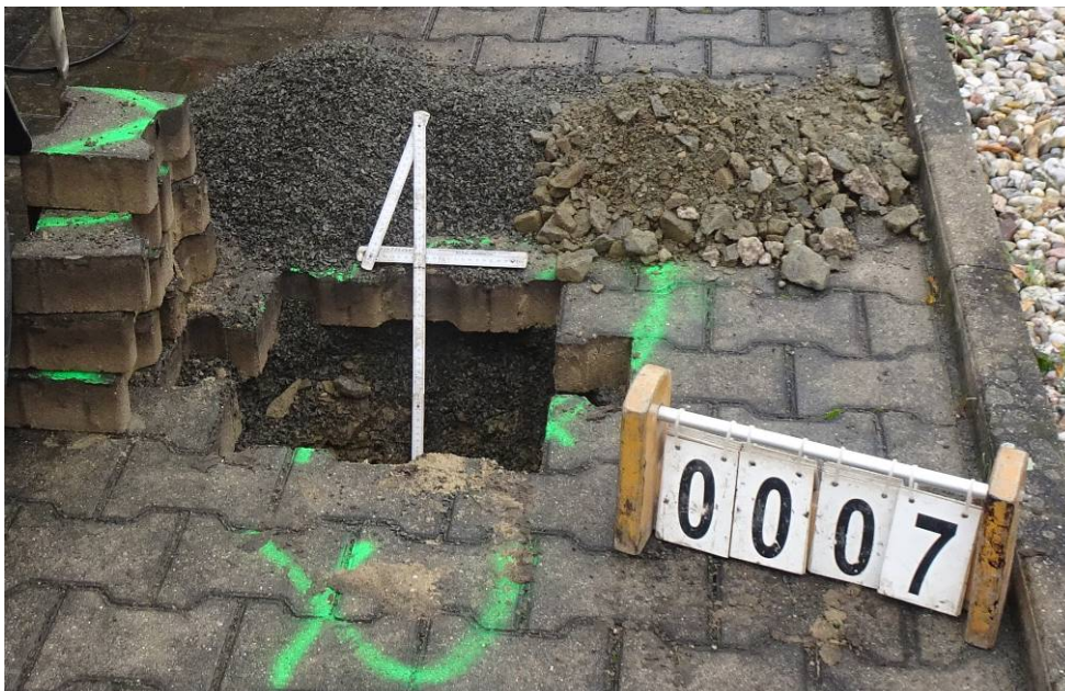
Bild 22: Entnahmestelle 7, Schurf S4 – GW Umstrukturierung Trinkwasserleitung Thallwitz – Lossatal 1. BA, Bereich Gehweg Material der einzelnen Schichten ausgebaut
