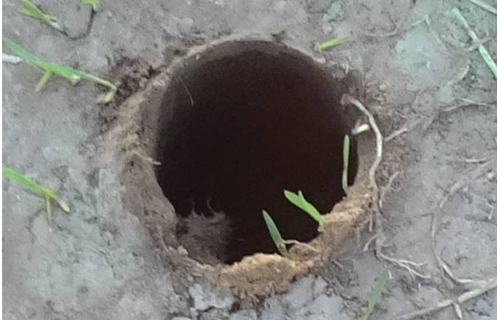
Bild 49: Entnahmestelle 15, Rammkernsondierung RKS 11 Umstrukturierung Trinkwasserleitung Thallwitz – Lossatal 1. BA, Bereich Feld Blick in Sondierstelle
