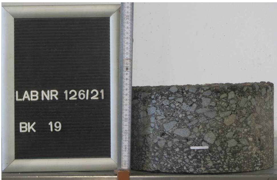
Bild 62: Entnahmestelle 19 Umstrukturierung Trinkwasserleitung Thallwitz – Lossatal 1. BA, Bereich Fahrbahn Detail Bohrkern Entnahmestelle 19, Ø 300 mm
