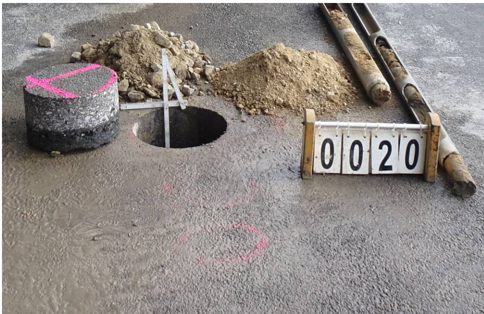
Bild 64: Entnahmestelle 20, Schurf S8 – FB / Rammkernsondierung RKS 15 Umstrukturierung Trinkwasserleitung Thallwitz – Lossatal 2. BA, Bereich Fahrbahn Material der einzelnen Schichten ausgebaut
