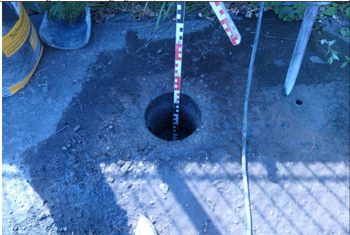
Kernbohrung 4, Kappenbereich, Durchmesser 150 mm
