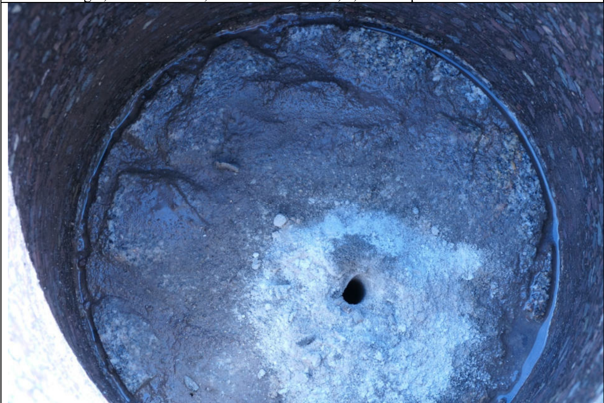
Kernbohrung 2, Brückendamm, Pflasterlage aus Naturstein, Granit, Kantenlänge ca. 9 cm x 5 cm x 7,5 cm (unterschiedliche Formate), nachfolgend Beton
