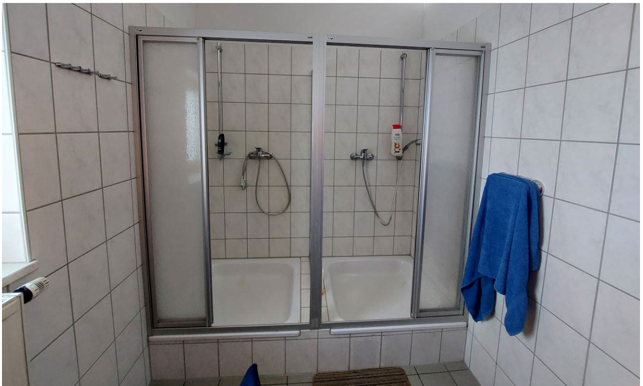
Sozialgebäude – Duschanlage Damen
