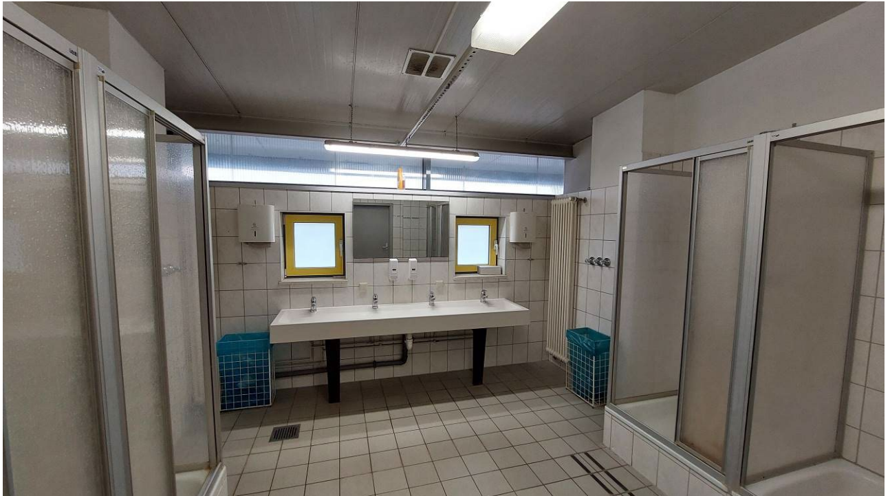
Sozialgebäude – Duschanlage Herren
