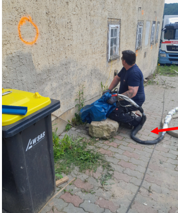
Abb. 8: Über einen 50 m langen Injektionsschlauch werden die zwei Komponenten des Expansionsharzes vom LKW zu den Injektionsstellen befördert. In der Injektionspistole erfolgt die kontrollierte Vermengung der beiden Komponenten.
