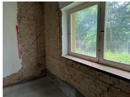
Abb. 2: Im Innenbereich sind die Schäden deutlich sichtbar.
