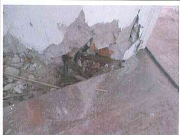
Gebäudeteil Mitte Flur Südseite Deckenbalkenaufleger vollständig zerstört
