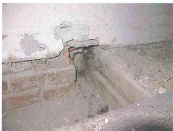
Freilegung Balkenaufleger Gebäudeteil West Deckenbalkenaufleger zerstört
