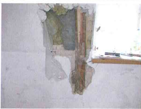
Stiele seitlich der Gauben zerstört (beispielhaft)
