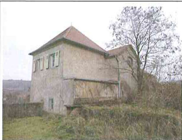
Südfassade Gebäudeteil West und Mitte Feuchtigkeitsschäden am Mauerwerk Dachentwässerung und Fallrohr defekt
