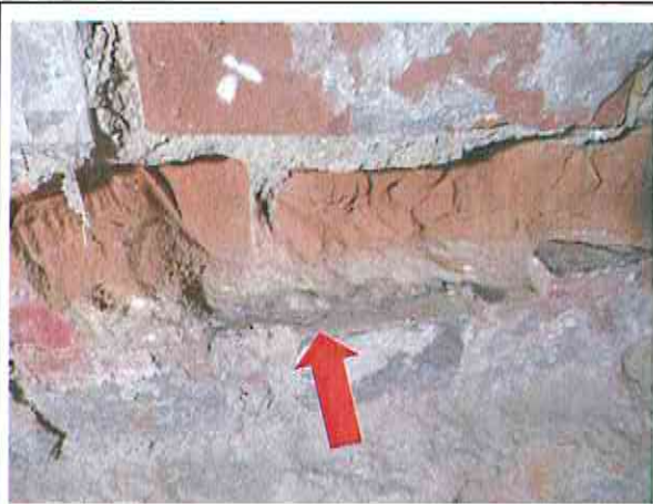
Horizontalsperre als Dachpappe im Kellergeschoss (beispielhaft)
