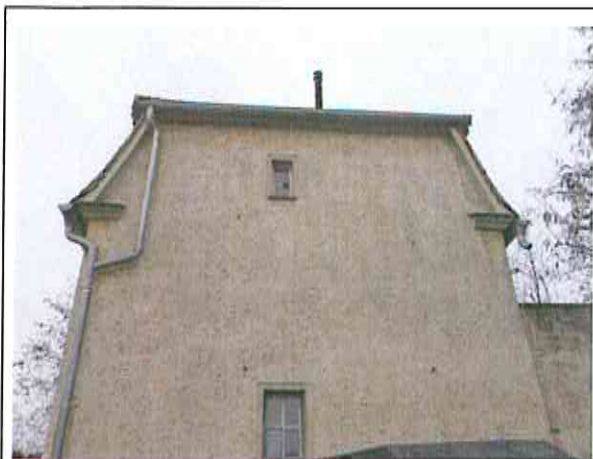
Ostgiebel Risse im Fassadenbereich - beispielhaft
