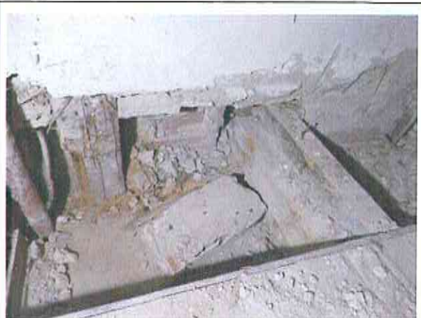
Freilegung Balkenaufleger Gebäudeteil Ost im Bad, Deckenbalkenaufleger zerstört
