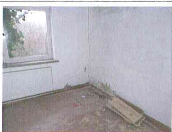
Gebäudeteil Mitte und Ost – EG, Nordseite Wand im Sockelbereich durchfeuchtet
