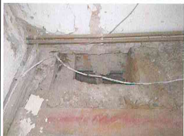
Gebäudeteil Mitte Raum 3 Nordseite Deckenbalkenaufleger vollständig zerstört
