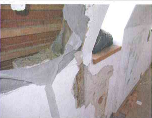
Stiele seitlich der Gauben zerstört (beispielhaft)
