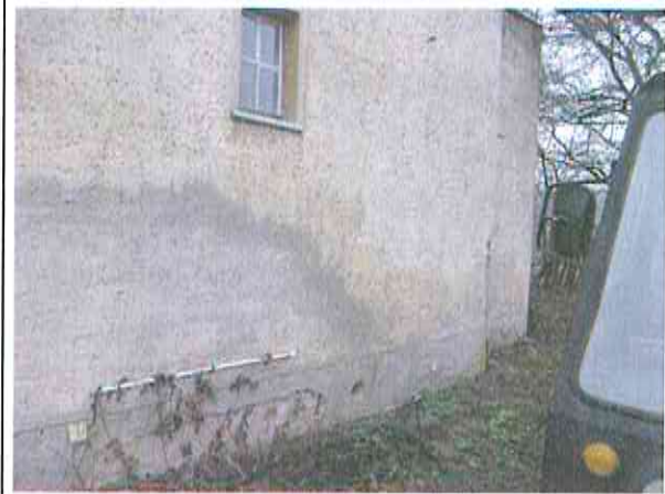
Ostgiebel Gebäudeteil Ost Feuchtigkeitsschäden am Mauerwerk Feuchtigkeitshorizonte und Putzschäden
