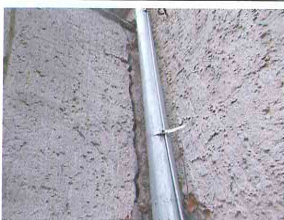
Gebäudeteil Ost Vorsprung „Freisitz“, vertikal abgerissen
