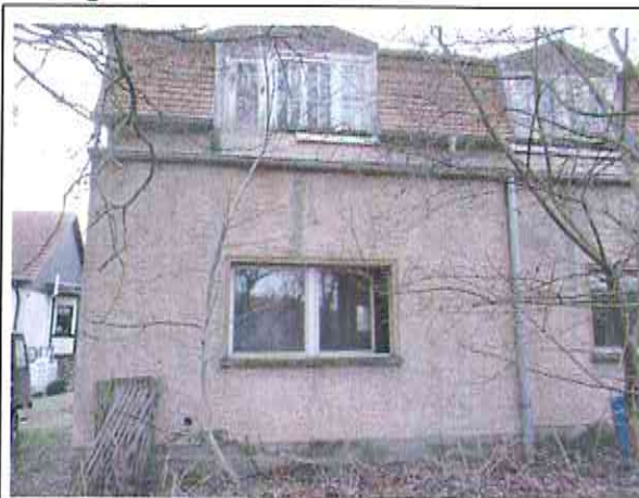
Gebäudeteil Ost Vorsprung „Freisitz“, Fenstersturz gerissen
