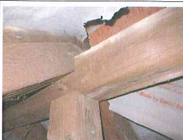
Dachgeschoss Gebäudeteil Mitte Sparrenköpfe durch Braunfäule geschädigt
