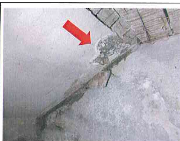
Kellergeschoss Treppe und angrenzende Flächen und Bauteile mit Befall durch den Echten Hausschwamm
