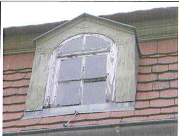
Dachgauben im Obergeschoss stark geschädigt
