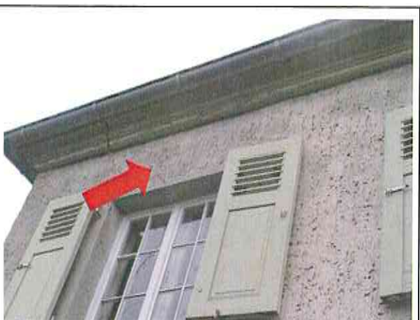
Westfassade Risse am Sturz beispielhaft
