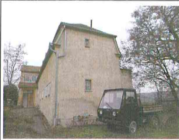
Ostgiebel Gebäudeteil Ost Feuchtigkeitsschäden am Mauerwerk Feuchtigkeitshorizonte und Putzschäden
