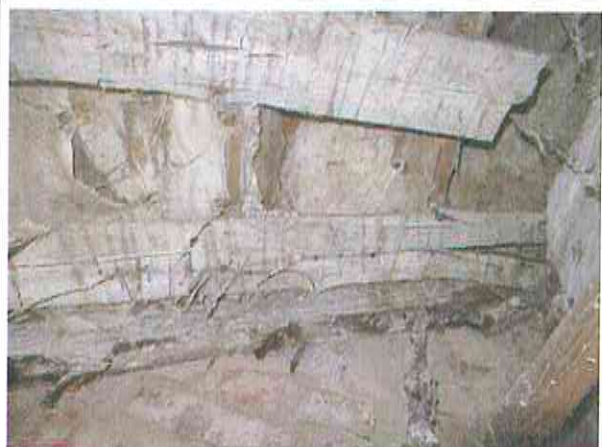
Treppe und angrenzende Flächen und Bauteile durch Echten Hausschwamm zerstört
