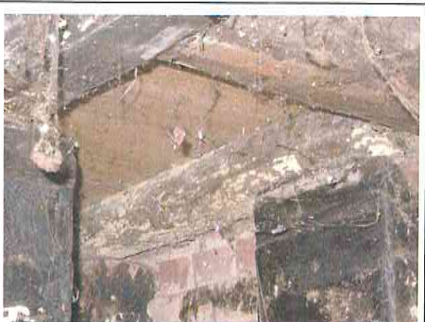
Teilbereich Ostseite Lagerhölzer mit Befall Gewöhnlicher Nagekäfer
