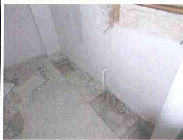
Freilegung Balkenaufleger Gebäudeteil Ost im Bad, Deckenbalkenaufleger zerstört
