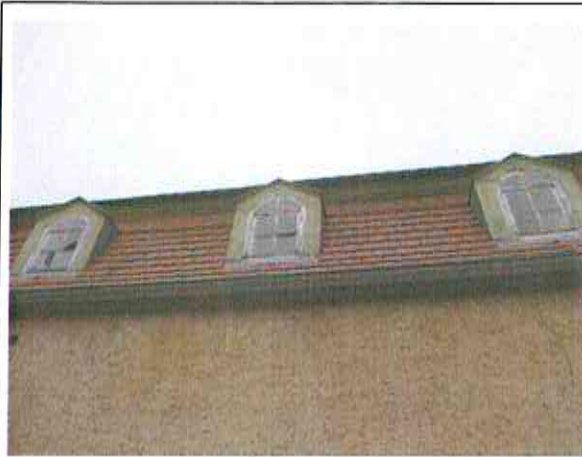
Dachgauben im Obergeschoss stark geschädigt
