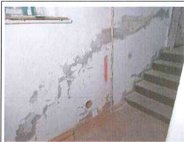
Gebäudeteil Mitte und Ost – EG, Südseite Wand bis Fensterbrüstung durchfeuchtet
