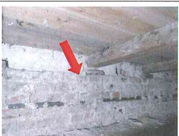
Bauwerksabdichtung gegen kapillar aufsteigende Feuchte als Dachbahn in einer Lagerfuge Gebäude Ost unterhalb Fußbodenniveau
