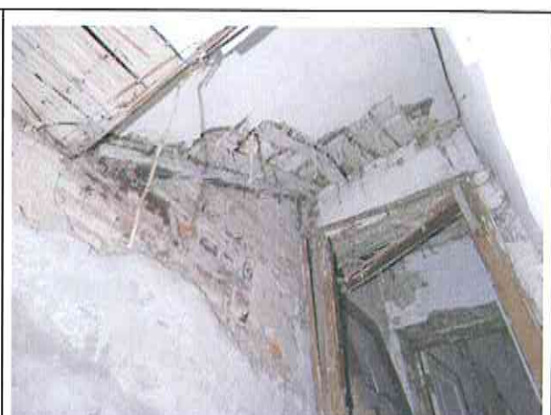
Kellergeschoss Treppe und angrenzende Flächen und Bauteile mit Befall durch den Echten Hausschwamm
