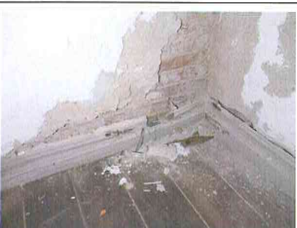
Treppe und angrenzende Flächen und Bauteile durch Echten Hausschwamm zerstört
