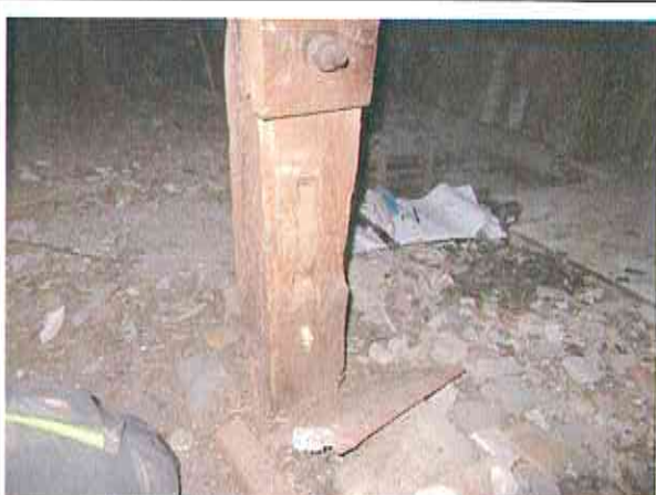
Dachgeschoss Gebäudeteil Mitte Schäden durch Larvenfraß des Hausbockkäfers
