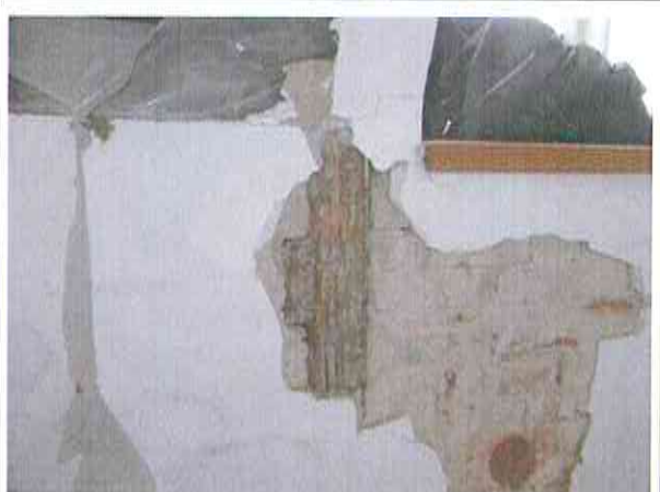
Stiele seitlich der Gauben zerstört (beispielhaft)
