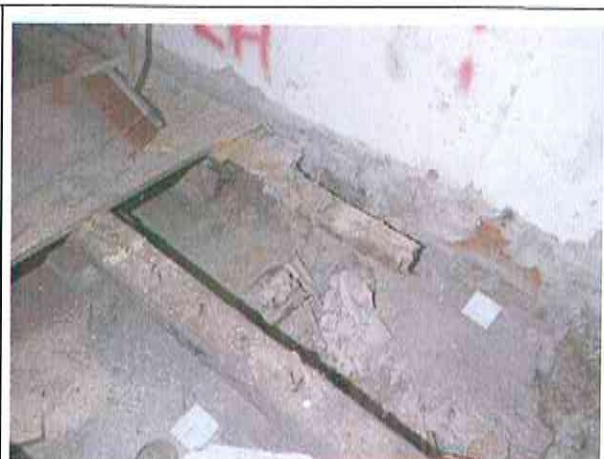
Gebäudeteil West Fußboden im Anschluss zur Treppe, Befall Echter Hausschwamm
