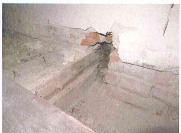
Freilegung Balkenaufleger Gebäudeteil West Deckenbalkenaufleger zerstört
