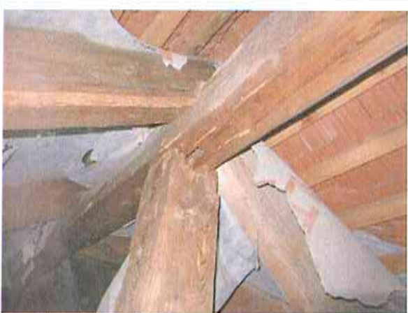
Dachgeschoss Gebäudeteil Mitte Schäden durch Larvenfraß des Hausbockkäfers
