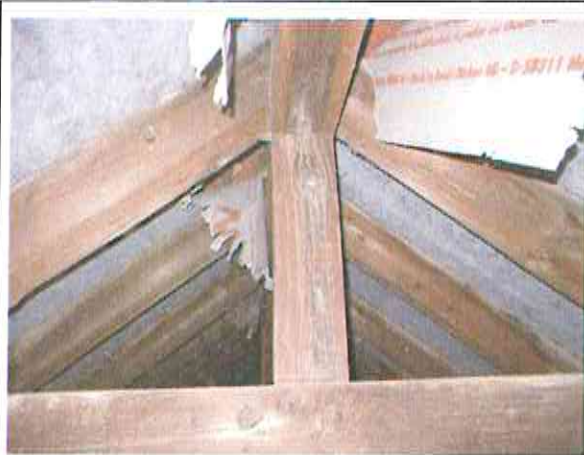
Dachgeschoss Gebäudeteil Mitte Stiel und Firstpfette durch Braunfäule geschädigt
