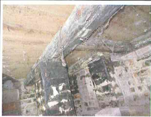
Teilbereich Ostseite Lagerhölzer mit Befall Gewöhnlicher Nagekäfer
