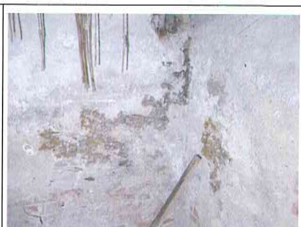
Kellergeschoss Treppe und angrenzende Flächen mit Befall Echter Hausschwamm Fruchtkörper auf den Wandoberflächen
