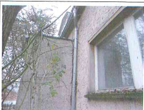
Gebäudeteil Ost Vorsprung „Freisitz“, vertikal abgerissen
