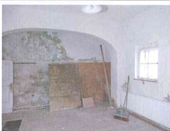
Gebäudeteil West – EG, Südseite Wand raumhoch durchfeuchtet
