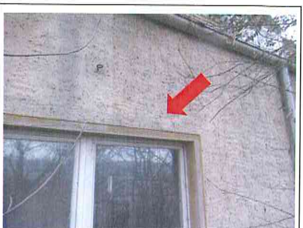
Gebäudeteil Ost Vorsprung „Freisitz“, Fenstersturz gerissen
