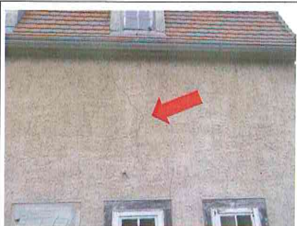
Riss im Verlauf der Fensterachse beispielhaft
