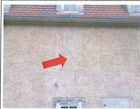
Riss im Verlauf der Fensterachse beispielhaft
