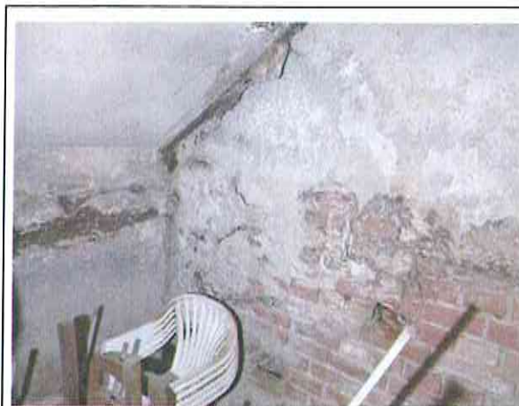
Kellergeschoss Treppe und angrenzende Flächen mit Befall Echter Hausschwamm Fruchtkörper auf den Wandoberflächen
