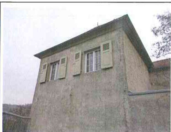
Westfassade Risse im Fassadenbereich - beispielhaft
