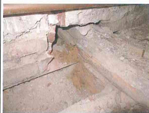
Gebäudeteil Mitte Raum 3 Nordseite Deckenbalkenaufleger vollständig zerstört
