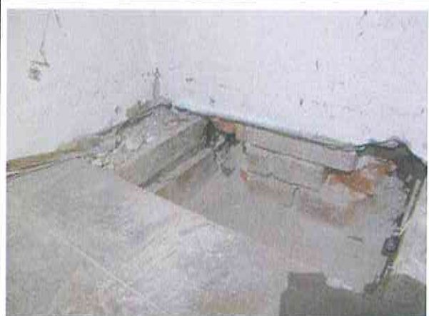
Freilegung Balkenaufleger Gebäudeteil West Deckenbalkenaufleger zerstört
