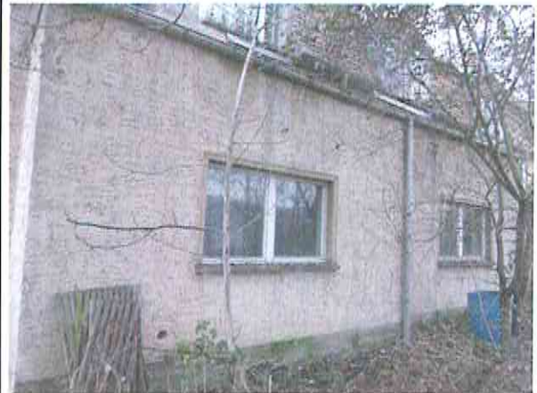
Nordfassade Gebäudeteil Ost Feuchtigkeitsschäden am Sockelmauerwerk
