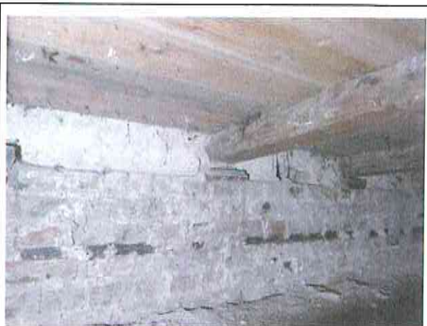
Lagerhölzer im Außenwandbereich am Sockel ohne Auflager
