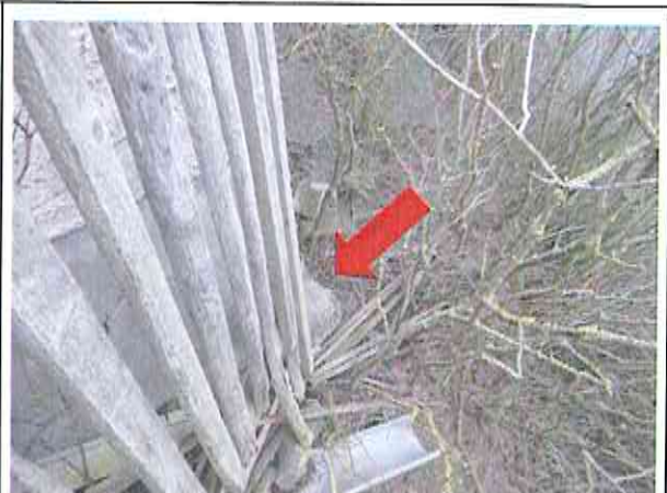
Gebäudeaußenecke Gebäudeteil West Fundament/Gebäudesockel am Hang freiliegend
