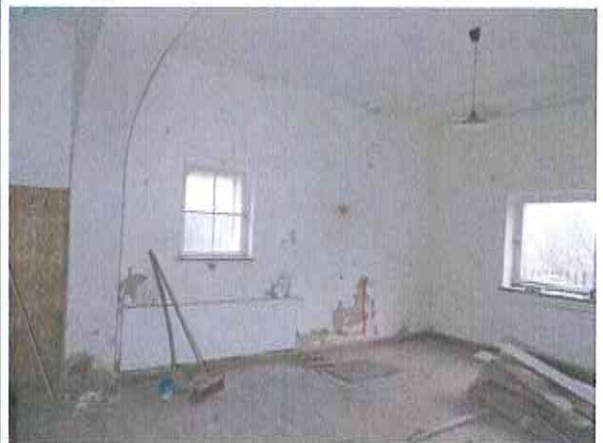
Gebäudeteil West – EG, Westseite Wand bis Fensterbrüstung durchfeuchtet
