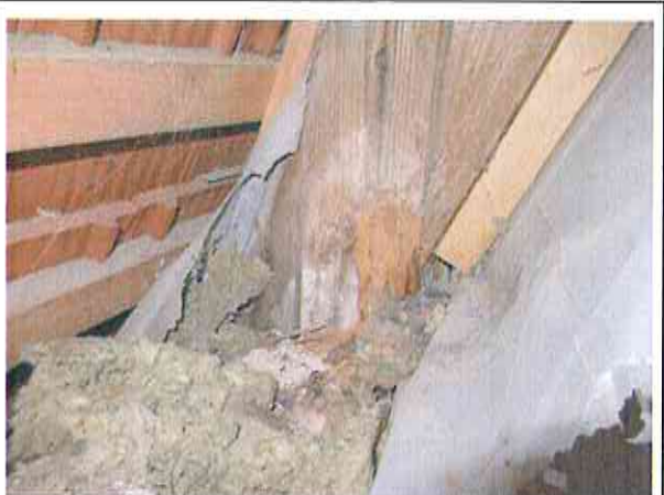
Stiele seitlich der Gauben zerstört (beispielhaft)
