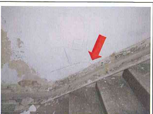
Treppe und angrenzende Flächen und Bauteile durch Echten Hausschwamm zerstört Befall bis Treppenlauf zum OG
