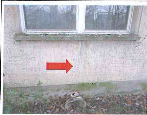
Gebäudeteil Ost Riss Brüstung beispielhaft
