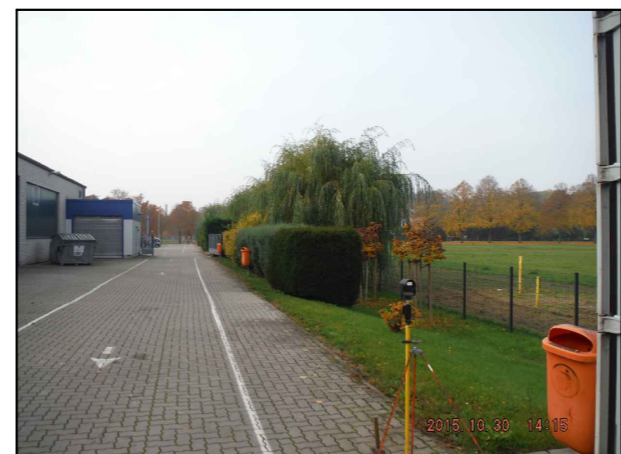
Station 0+590: Gelände Autohaus, Vorblick auf Richtung Gutenbergstraße, gepl. HWSA entlang Grundstücksgrenze (im Böschungsbereich), Rodung Geholze und Neuanordnung der Einfriedung
