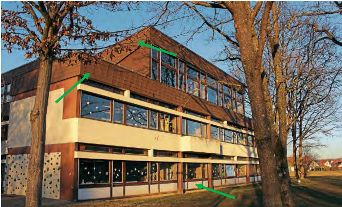
Übersicht (Pfeile mit Verdacht auf Asbestzement-Produkte)
