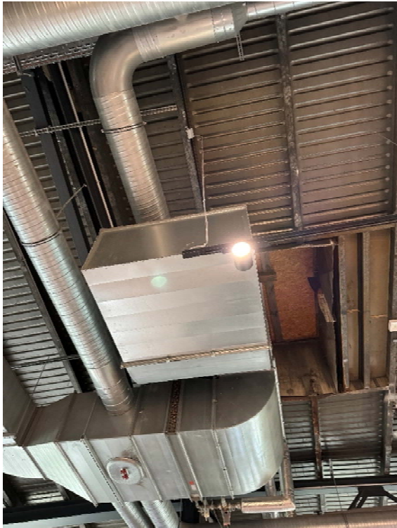
Lüftung Decke 1.OG
