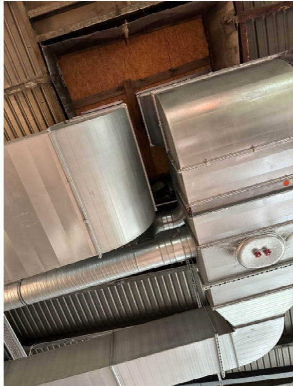
Lüftung Decke 1.OG
