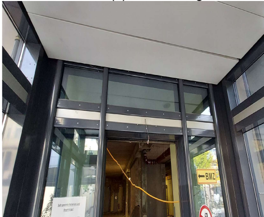
Ansicht von innen (5) - Innenanlage im Windfang + Decke
