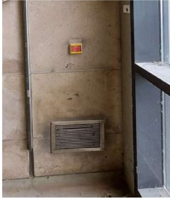
Ansicht Lüftungsauslass in Natursteinfass. (- neu mit Glattblech)
