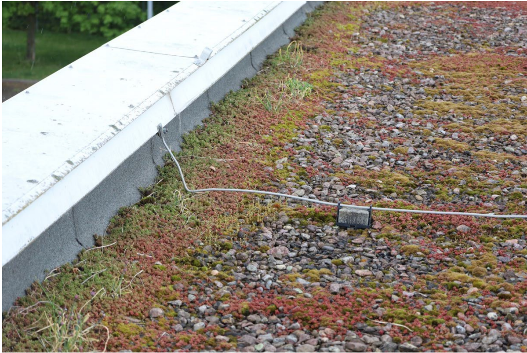
Abb. 20: Blitzschutz 1 - Anbindung Attika-Verkleidung
