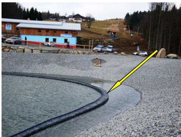
verlegte Luftleitung z.B. auf den Gabionen in einem Beschneungsteich für die Teichbelüftung
