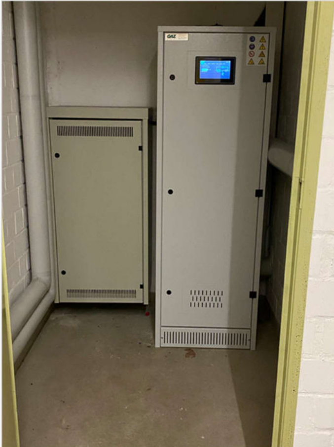
Notstromanlage und Batterieschrank im Raum R 1.01
