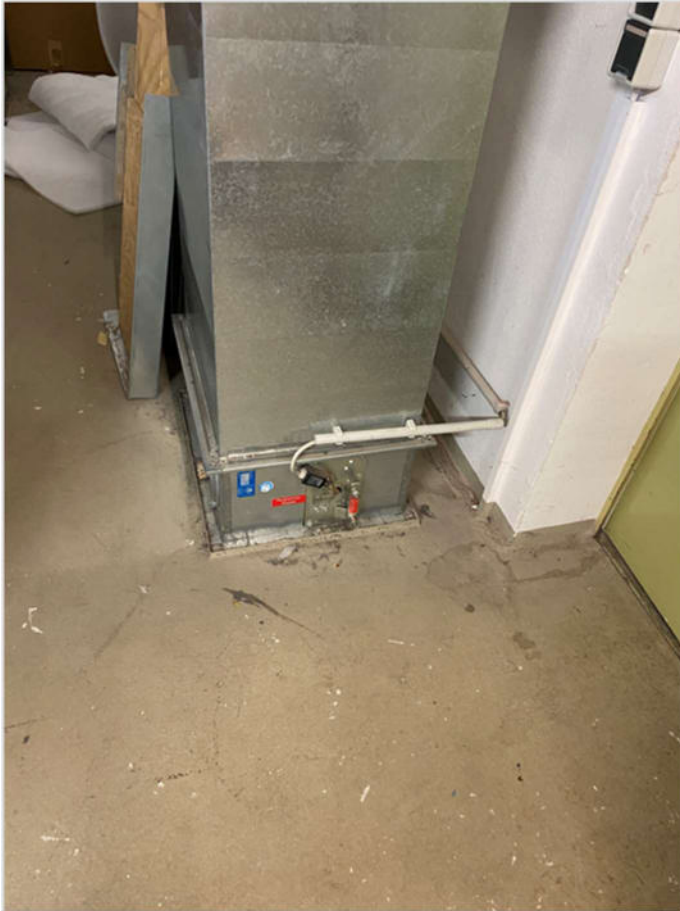
geschotteter Deckendurchgang der Lüftungsanlage im Raum R 2.04
