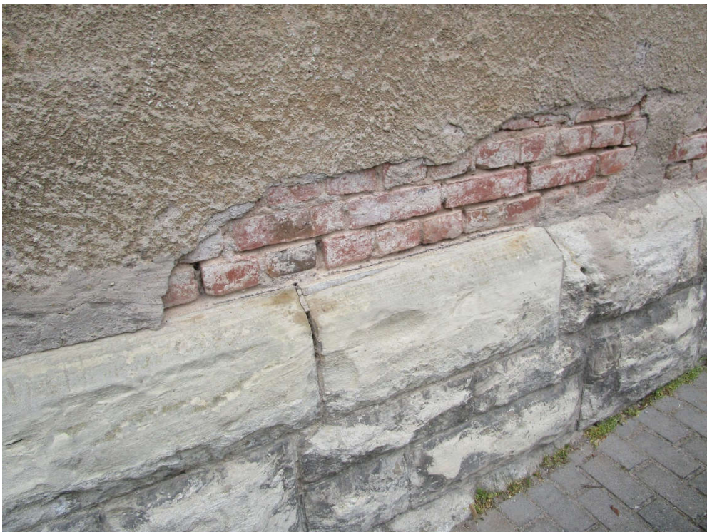
Detail Putzschäden Außenfassade
