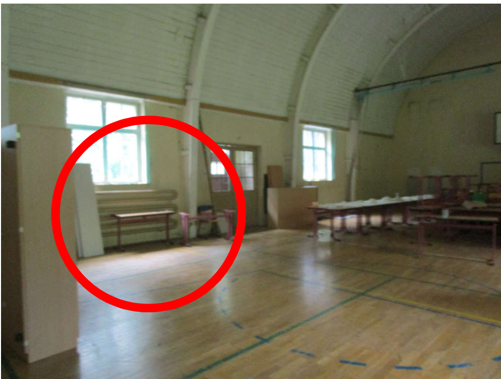
Veraltetes Heizsystem im Turnraum
