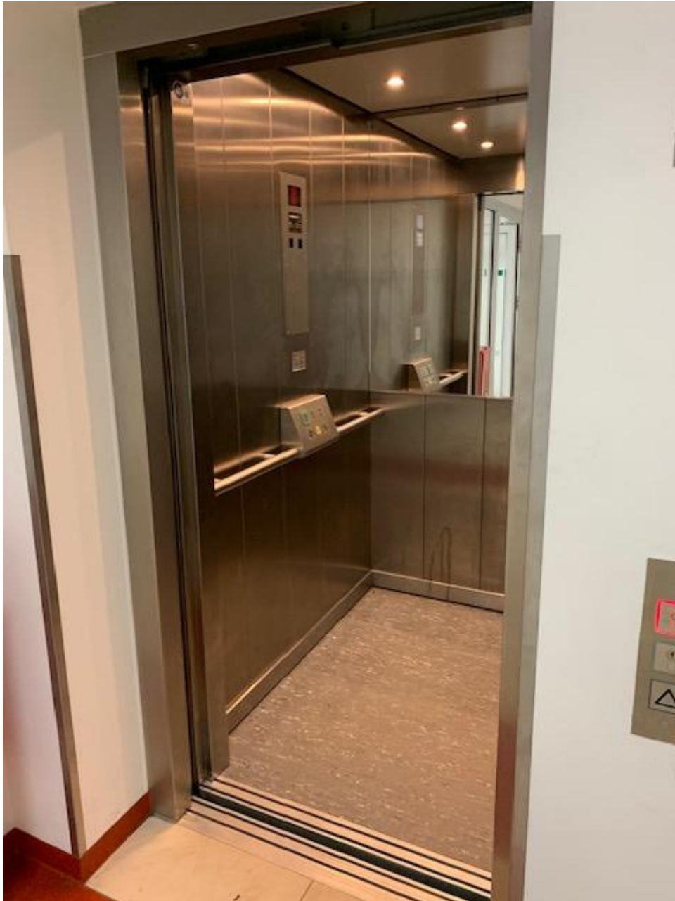
Aufzugtür: Höhe: 200cm, Breite 90 cm Aufzuginnenbereich: Höhe: 220cm, Breite 100cm, Tiefe: 137cm
