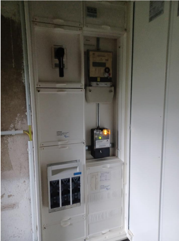
Hauptverteiler Storm und Zählerplatz
