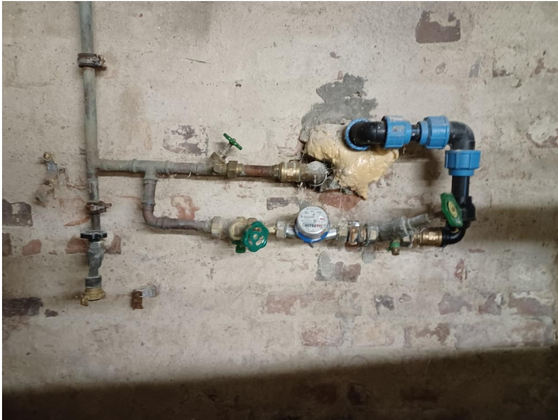
Unterzähler Wasser im KG
