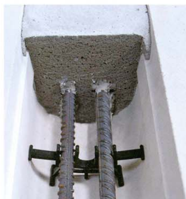
Die guten Brandschutzeigenschaften liegen darin begründet, dass der Betonkern und die Bewehrung an drei Seiten von KS-Schalen geschützt werden.
