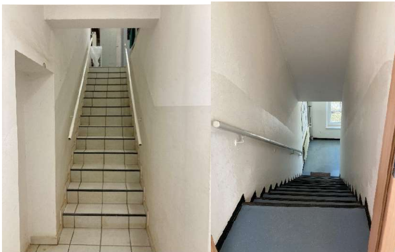
Reiche Zeche – Zustand der vertikalen Erschließung
